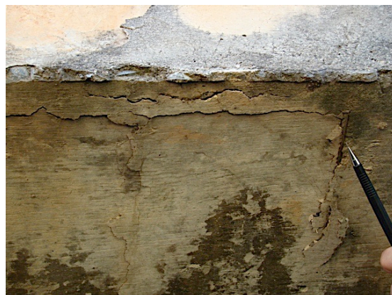
Figura 2: corrosão de armadura ( F_i = 3 )
