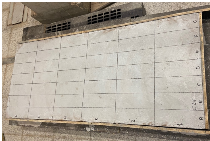
Figura 3.14 – Divisão dos pontos de leitura de tomografia ultrassônica para detecção de danos em laje de concreto.
