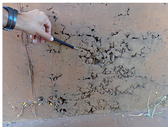
Figura 12: falha de concretagem ( F_i = 2 )
