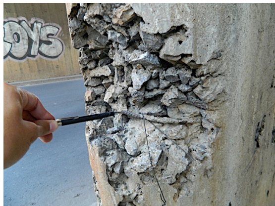
Figura 13: falha de concretagem ( F_i = 3 )
