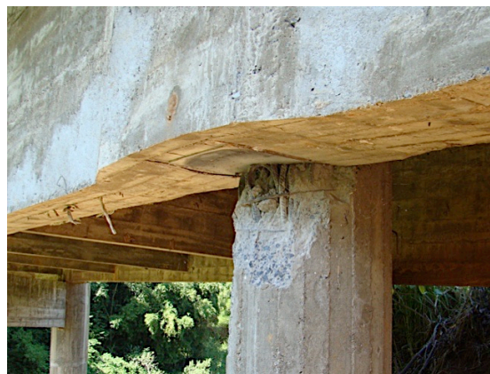
Figura 20: sinais de esmagamento do concreto ( F_i = 4 )
