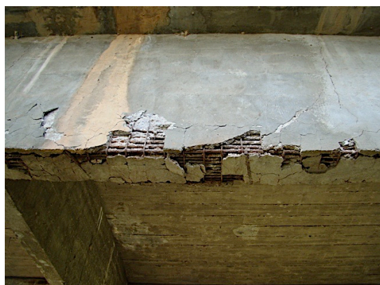
Figura 15: falha de concretagem ( F_i = 4 )
