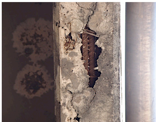
Figura 1: corrosão de armadura ( F_i = 2 )
