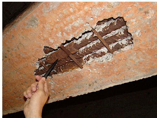
Figura 14: falha de concretagem ( F_i = 3 )
