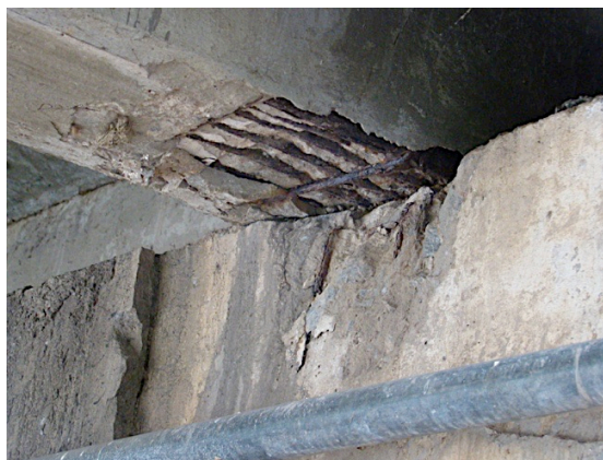
Figura 19: sinais de esmagamento do concreto ( F_i = 3 )
