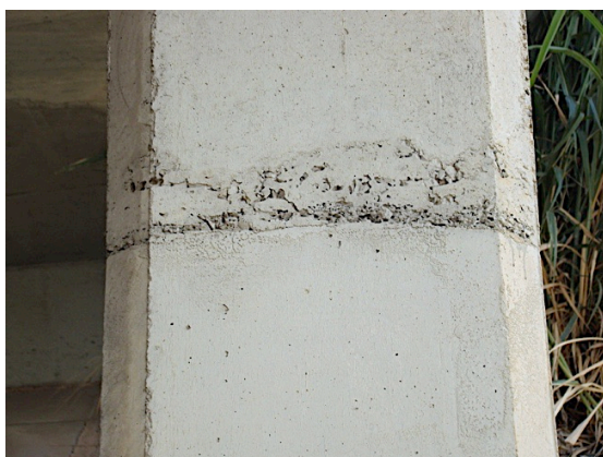
Figura 11: falha de concretagem ( F_i = 1 )
