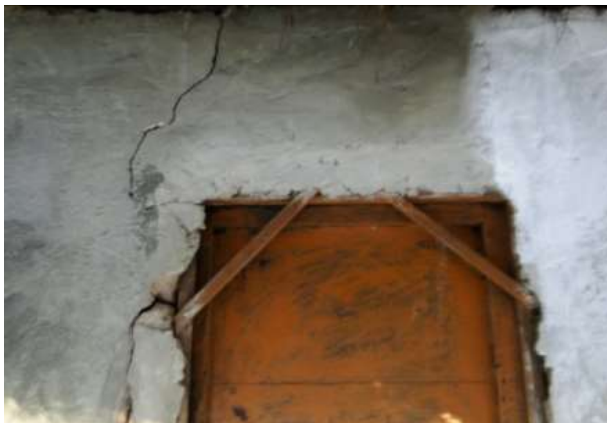
FIGURA 84: RACHADURA PROVOCADA PELA CIRCULAÇÃO DOS TRENS.
