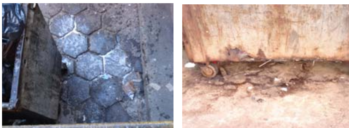
Figura 24 – Vazamento de chorume no pátio do Cais e contêineres mal conservados
