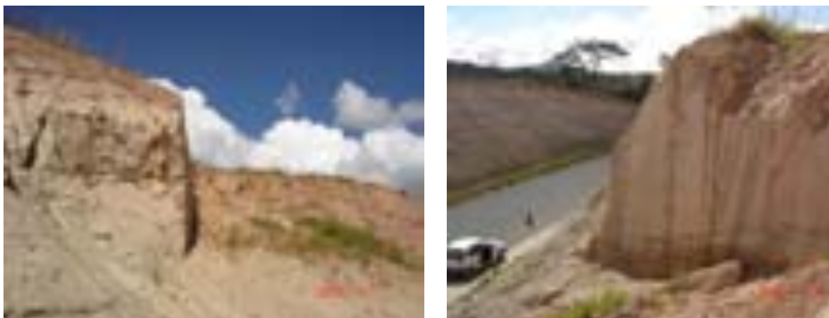
Figura 6.10 – Detalhes dos processos de deslizamentos ao longo das xistosidades e dos planos de falhamento/fraturamento, foto 2005.
