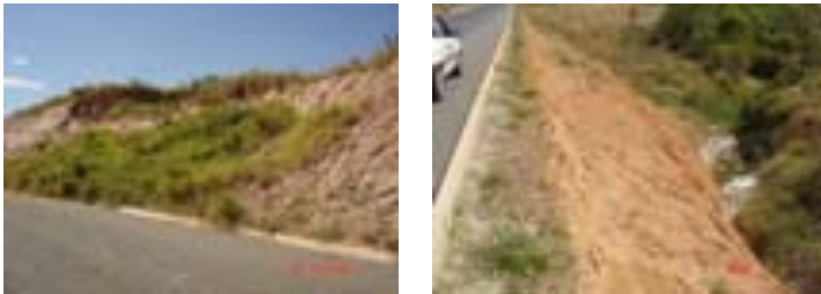
Figura 6.2 – Deslizamentos em taludes de corte e aterro.
