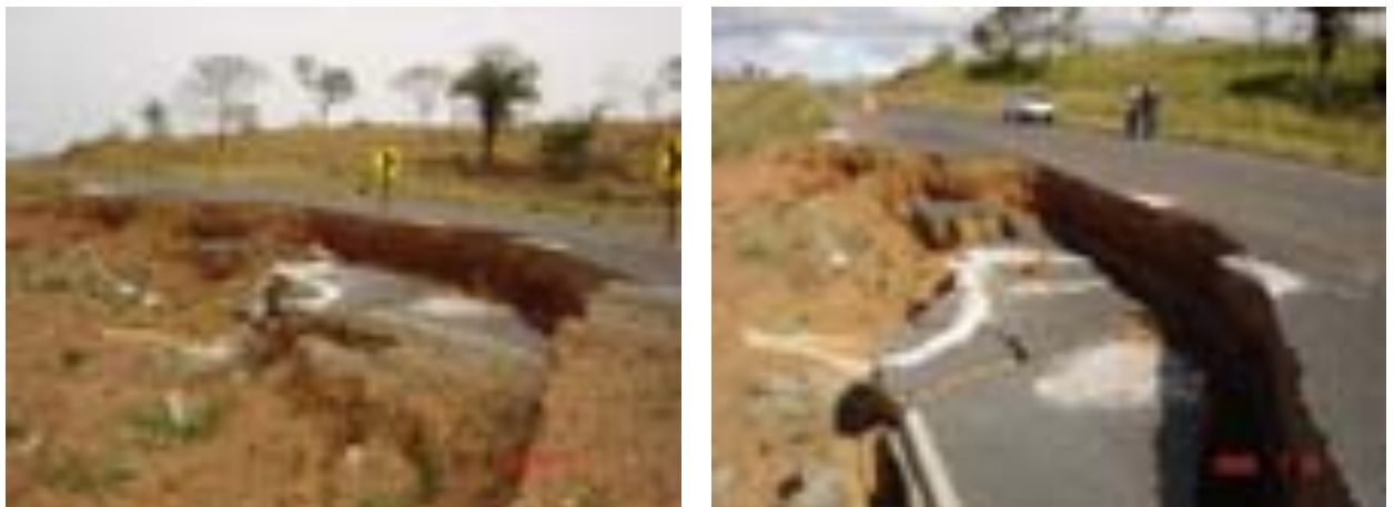
Figura 6.7 – Recalque em talude de aterro.
