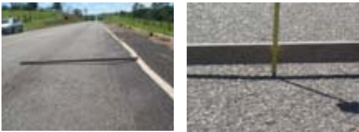
Figura 6.12 – Abatimento de aterro km 12 – lado esquerdo, foto 2010.
