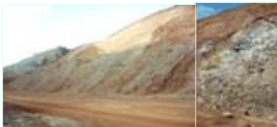
Figura 3.4 – Detalhe do processo de solifluxão em talude da rodovia BR-414/GO, km 09, em 2000.
