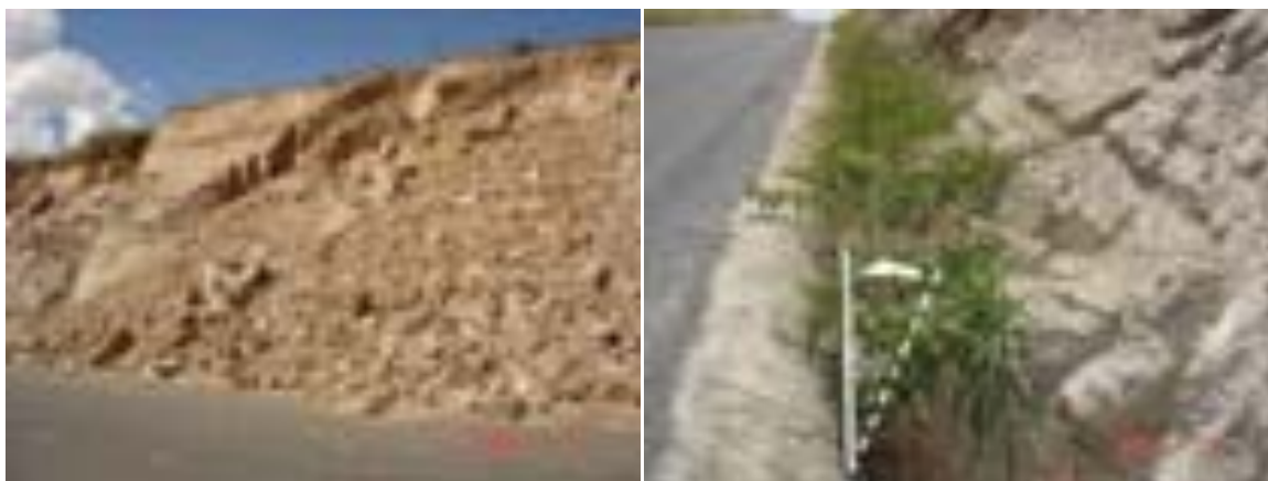
Figura 6.3 – Processo de queda de blocos, e processo de rastejo em talude de corte
