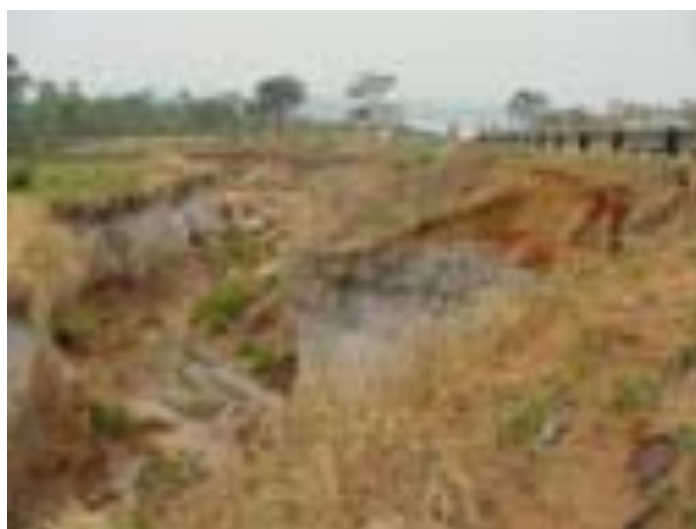
Figura 3.2 – Erosão na rodovia - BR 070/GO, km 3,00 (Águas Lindas-GO). Fonte: foto do autor, 2005.
