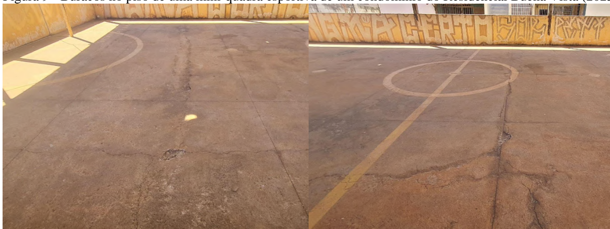
Figura 9 - Buracos no piso de uma mini-quadra esportiva de um condomínio do Residencial Buena Vista (2025)
