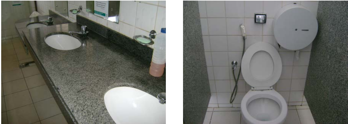
Figura 4. 9: Banheiros antes das intervenções.
