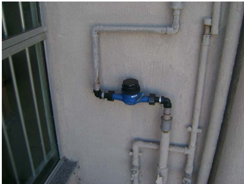
Figura 4. 11: Alimentador Predial após a instalação do hidrômetro.
