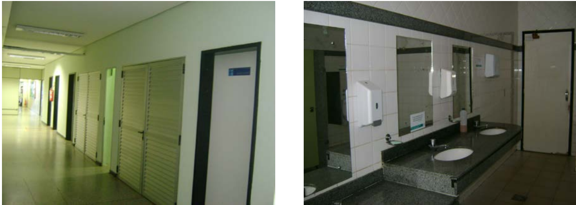
Figura 4. 8: Panorama da situação de conservação da edificação.
