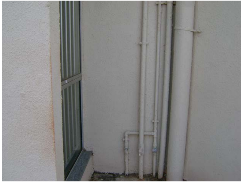
Figura 4. 10: Alimentador Predial antes da instalação do hidrômetro.
