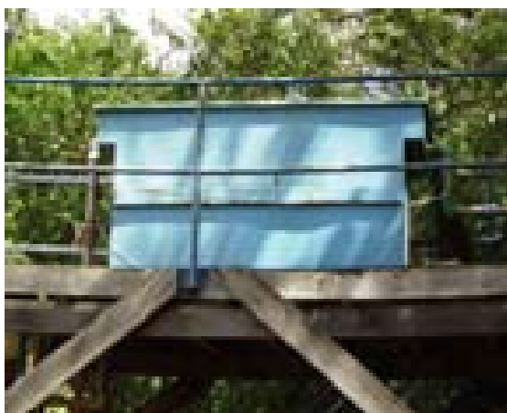
Figura 18 – Vista lateral do Pré-filtro dinâmico
