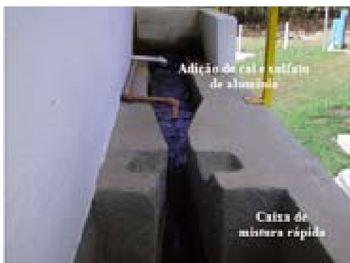
Figura 11 – Aplicação de produtos químicos na Calha Parshall
