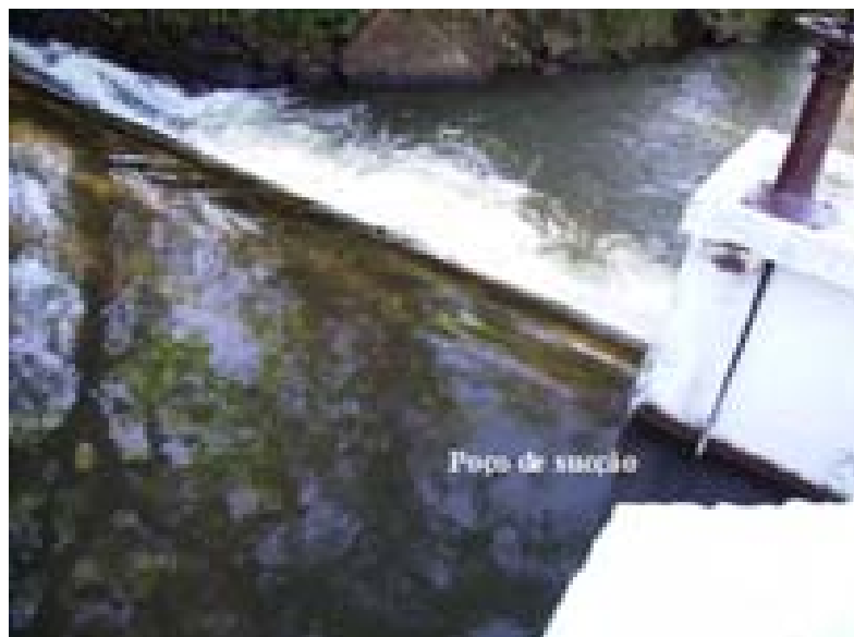
Figura 16 – Poço de sucção da ETA Goianópolis
