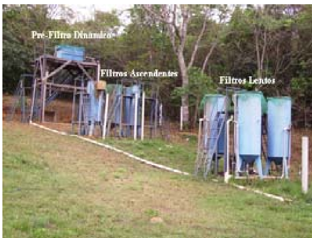
Figura 13 – Instalação piloto FiME em Goianápolis – GO
