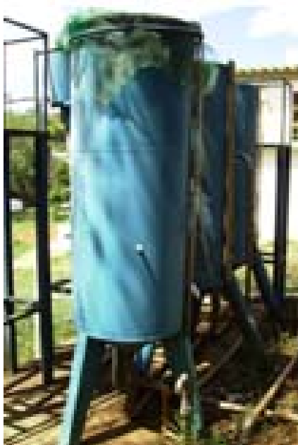
Figura 20 – Vista lateral do Pré-filtro Ascendente
