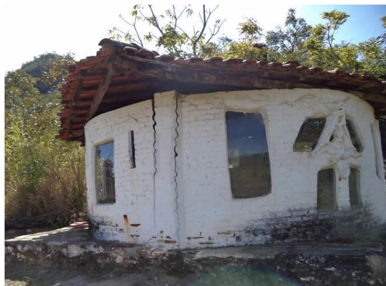
Figura 18 – Templo Tilak, em 2016, com a estrutura bastante danificada
