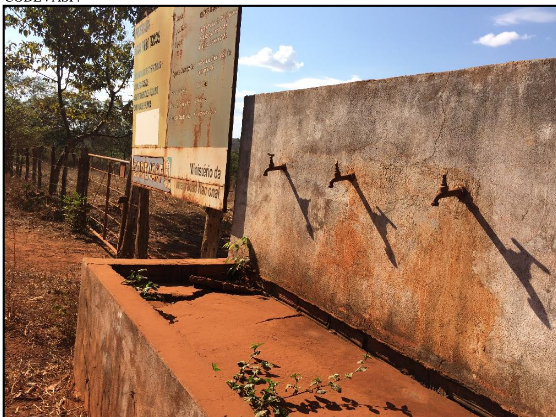
Figura 07. Registro de obra decadente feita pelo Ministério da Integração Nacional (MIN) e pela CODEVASF.
