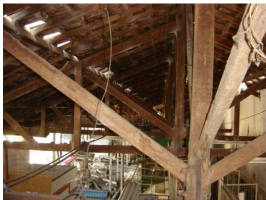
Figura 127 - Estrutura da cobertura antes da requalificação.
