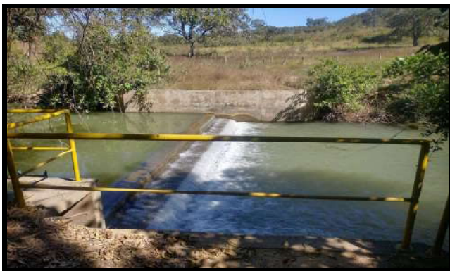
Figura 02A - Elevatória de Água Bruta do Rio Montes Claros/GO.
