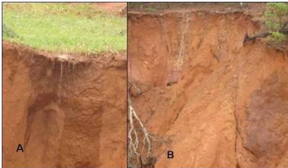
Figura 25. Escoamento superficial concentrado na cabeceira da voçoroca, (SOUSA, 2008).
