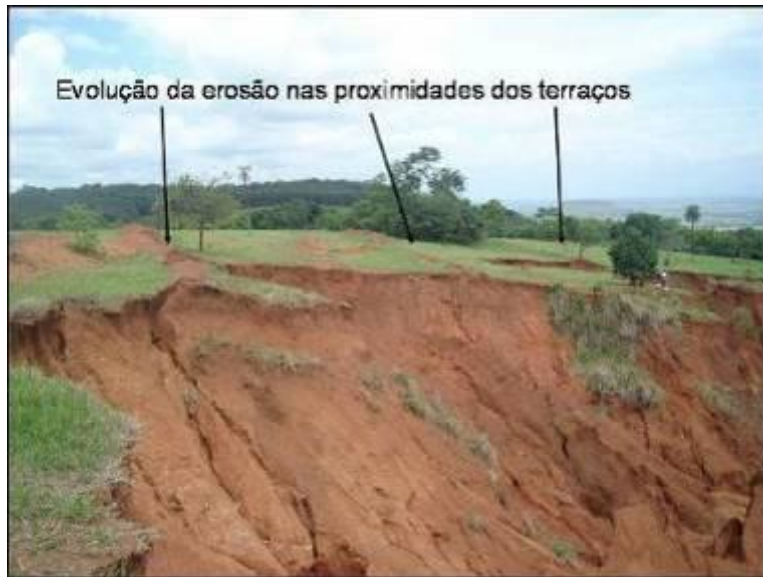
Figura 24. Vista parcial das ramificações muito instáveis do lado esquerdo da voçoroca, (SOUSA, 2008).
