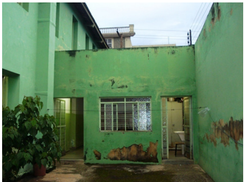
Imagem 69: Necessidade de manutenção do anexo I, bateria de sanitários, copa e cozinha. Fonte: Daniella Moreira Rocha, 2013.
