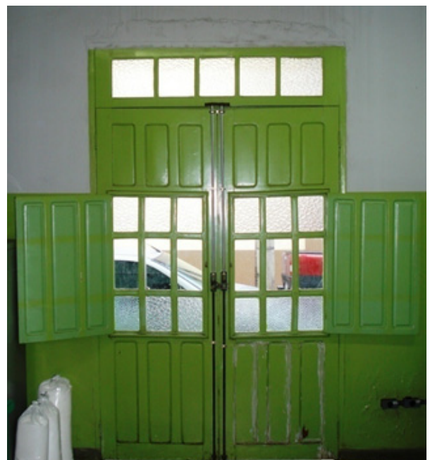
Imagem 76: Porta de entrada em madeira e vidro com bandeirola. Fonte: Daniella Moreira Rocha, 2013.
