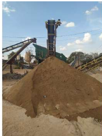
Figura 3.3 - Equipamento de britagem do tipo mandíbula fixa (SOUZA, 2023).
