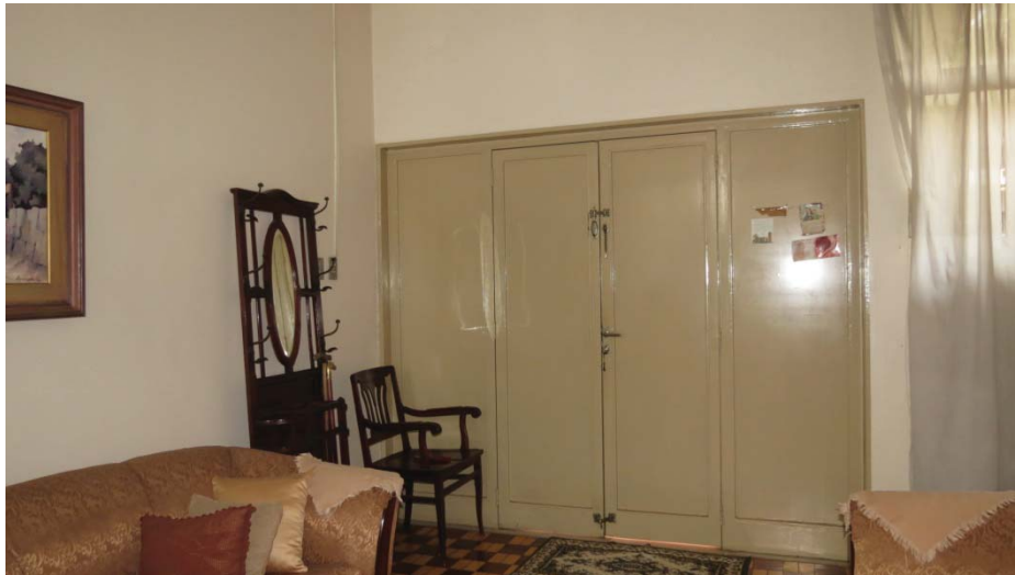
Figura 49 - Detalhe da alteração da porta de entrada: antes de madeira, hoje de ferro. Fonte: Isabela Menegazzo, setembro de 2012.
