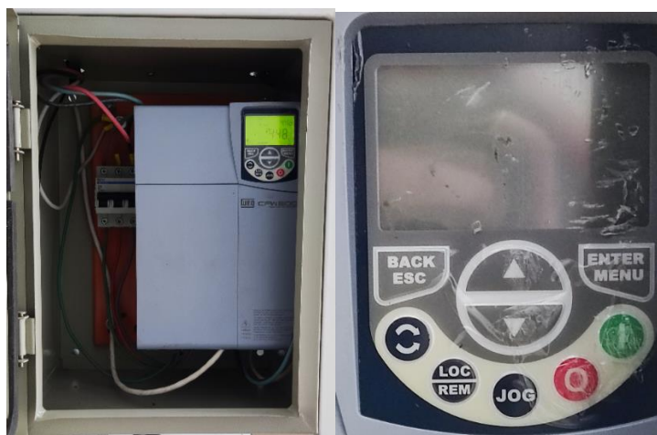
Figura 26. Inversor de Frequência no túnel de vento
