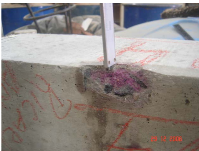
FIGURA 6.15 – Leitura da profundidade carbonatada.
