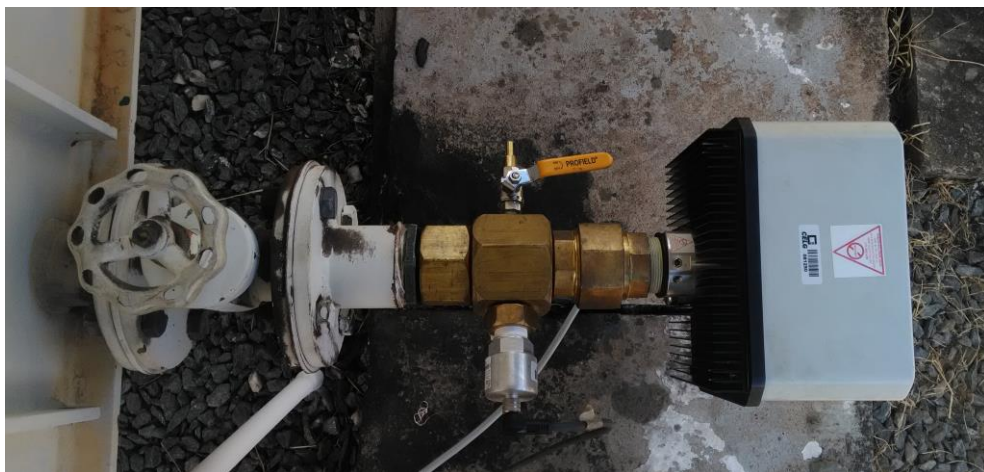
Figura 2.2. Registro do tipo gaveta em transformador
