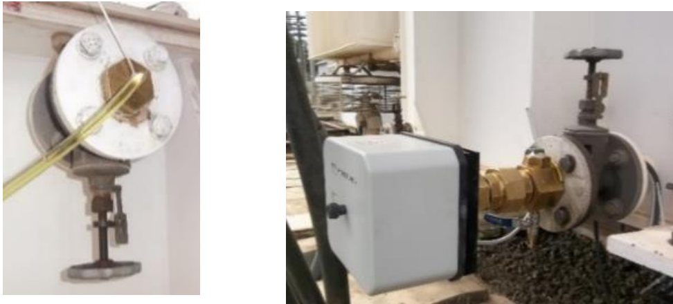
Figura 5.1. Montagem para registros de coleta de óleo de transformador, nos registros superior (foto esquerda) e inferior (foto direita)
