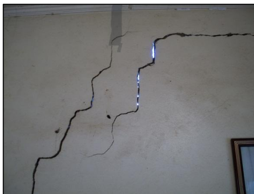
Rachaduras na parede da sala de Luiz.
