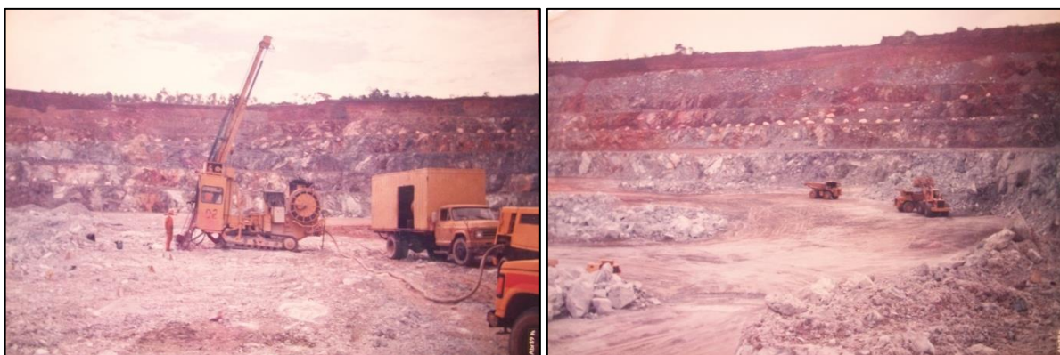
No centro da primeira fotografia (à esquerda), Augusto está posicionado de frente a uma perfuratriz. À direita, escavadeira que recolhe os pedaços do maciço rochoso, após as explosões, e caminhão-caçamba que transporta estas rochas até os britadores – fotografias reveladas em abril de 1989.
