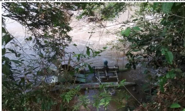
Figura 29 – Estrutura de captação de água instalada no Rio Paranã e utilizada para abastecimento de um domicílio.
