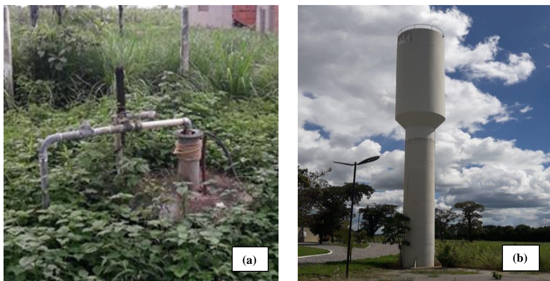
Figura 21 – Representação do poço tubular profundo (a) e do reservatório elevado (b) pertencentes ao SAA da Comunidade de Extrema.
