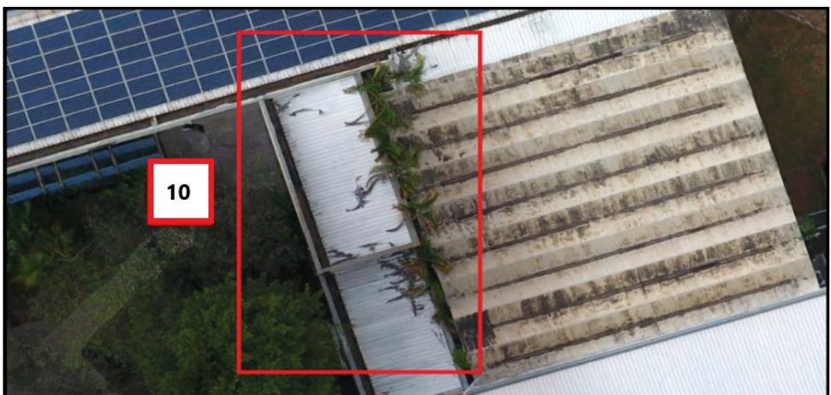
Figura 38 – Recorte fotográfico do mosaico obtido com drone Phantom 4 Pro, no qual é possível detectar muitos resíduos orgânicos proveniente de vegetação (detalhe 10) sobre o telhado e nas calhas no edifício da Faculdade de Artes
