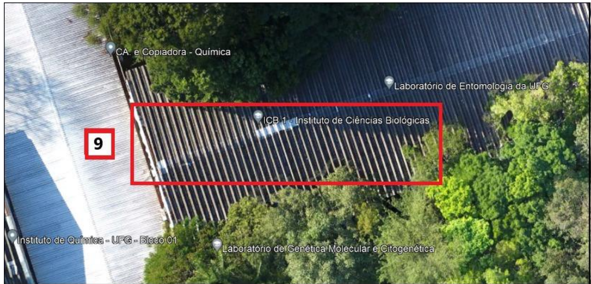
Figura 37 – Recorte fotográfico de um mosaico obtido com o drone Phantom 4 Pro Standard em 2020, no qual se observa que ocorreu reparo da avaria no telhado (detalhe 9) do edifício do ICB I
