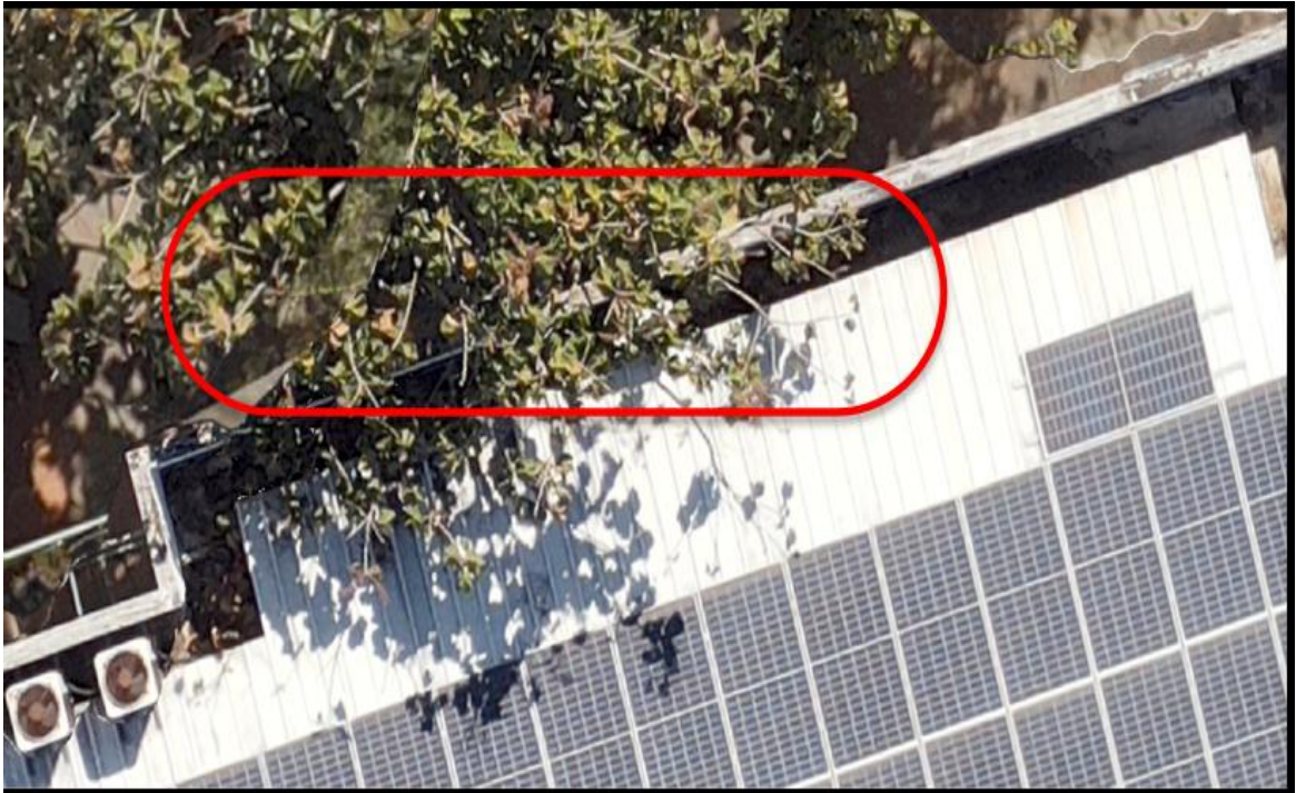
Figura 33 – Mosaico RGB obtido pelo drone Phantom 4 Pro, ilustrando o telhado do edifício do Iesa, com detalhe dos resíduos obstruindo a drenagem da calha
