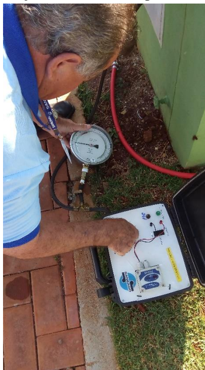
Figura 12 – Medição instantânea de pressão com manômetro
