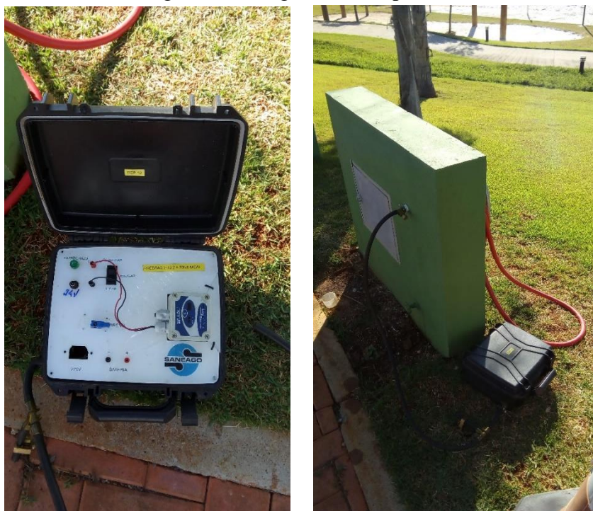
Figura 11 – Registrador de pressão
