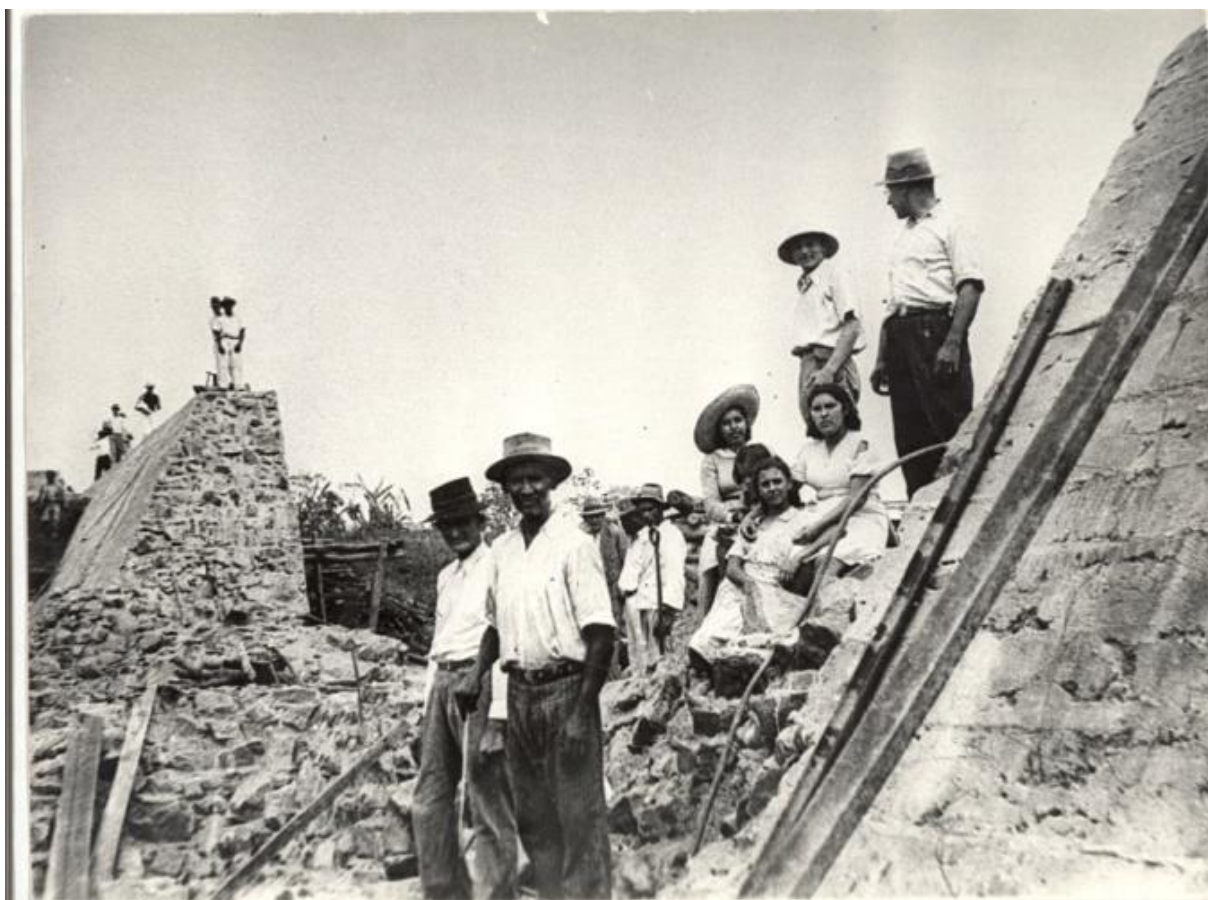
Figura 39: Barragem do Jaó após rompimento. Para sua reconstrução, estruturas que sobraram tiveram que ser demolidas. Fonte: AHE. Década de 1940.
