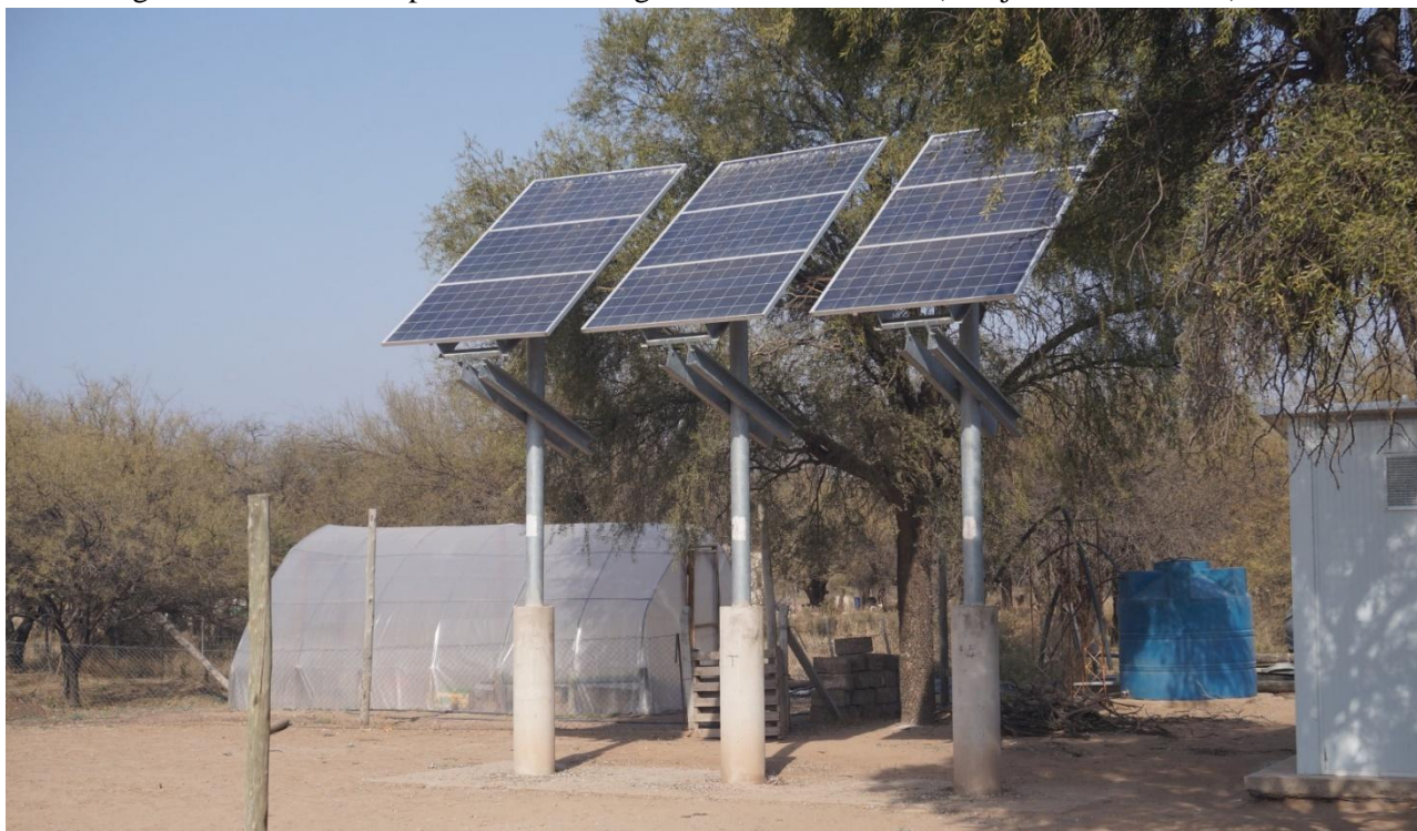
Figura 21 - Sistema de provisión de energía en escuelas rurales (Paraje Las Cortaderas).
