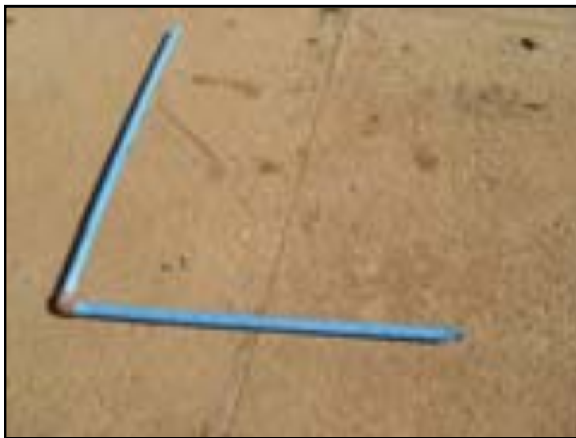
Figura 13 Tubo perfurado na parte horizontal utilizado na drenagem de gases dos leitos de macrófitas.
