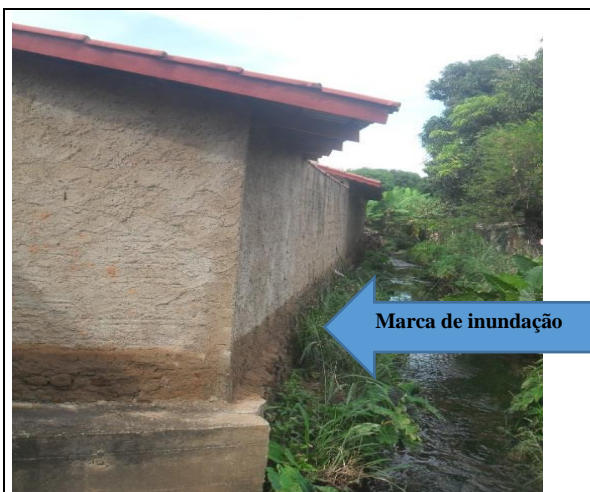
Figura 05: Construção de casa na margem do córrego Barreiro como causa de inundação. Fonte: BORGES, 2015.
