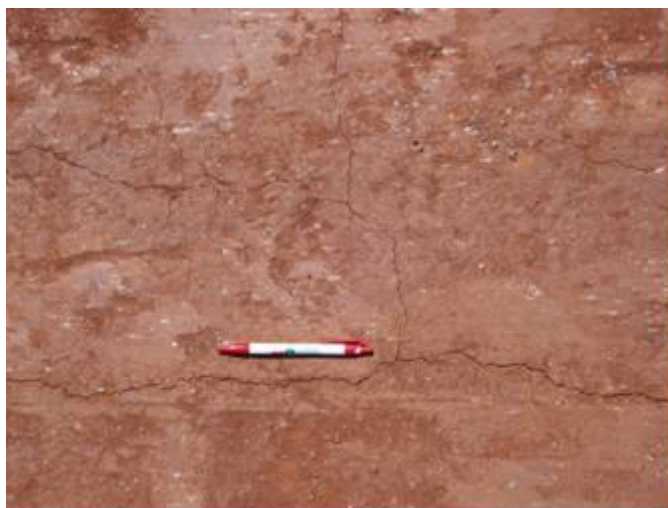
Figura 3.18 – Aspecto da base compactada após o trincamento.
