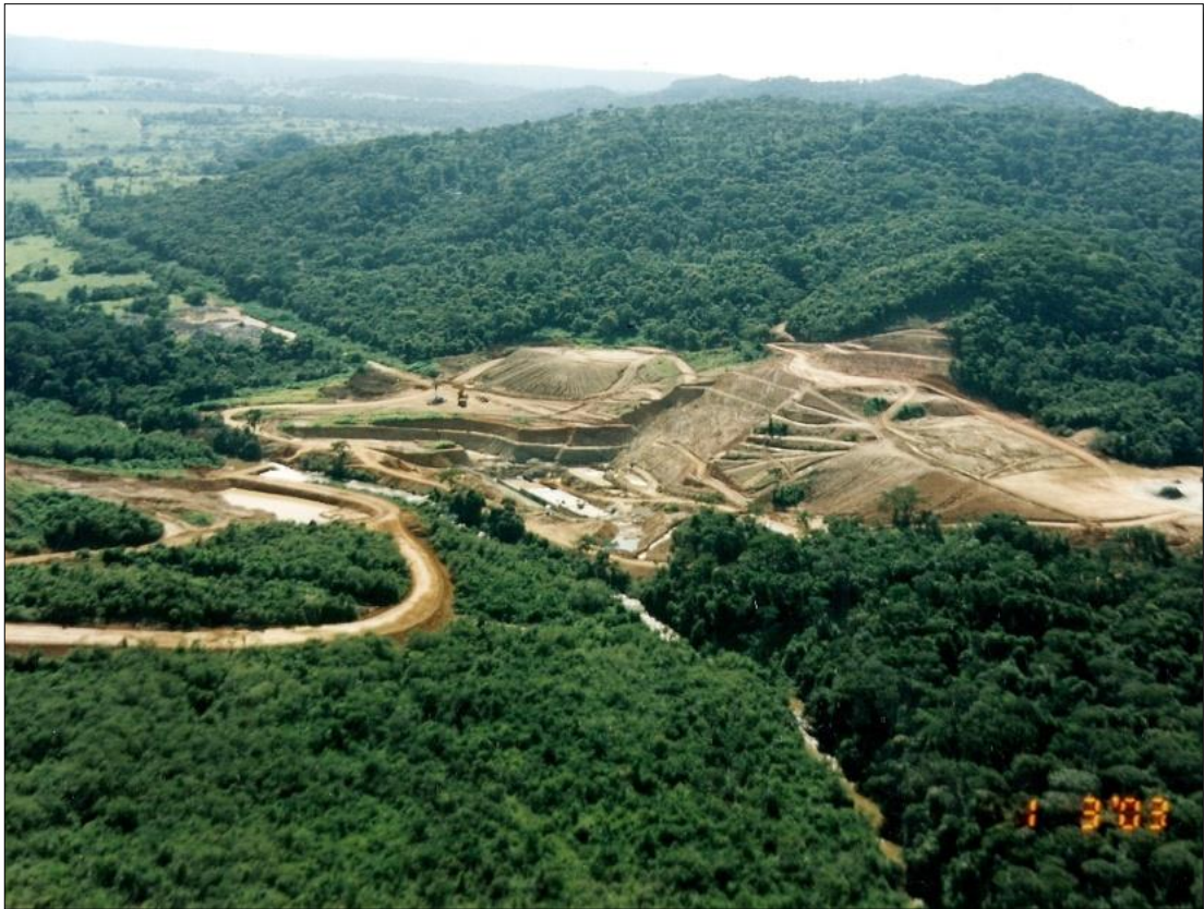
Figura 3 - Início da construção da Barragem do Ribeirão João Leite, região ainda com mata fechada Fonte: ASCOM/SANEAGO (Fevereiro de 2013)
