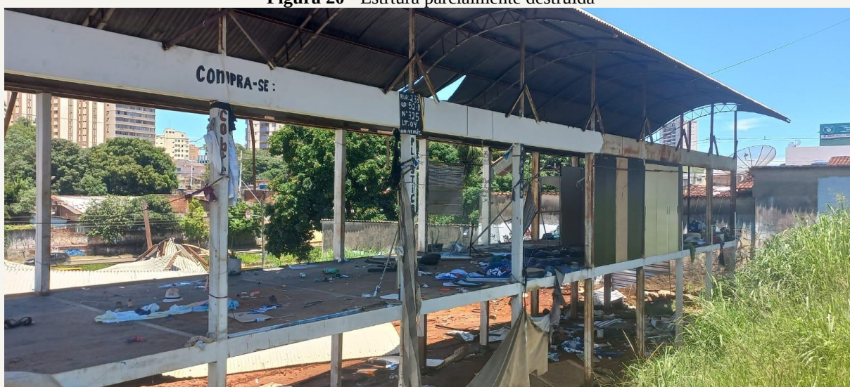
Figura 20 - Estrutura parcialmente destruída
