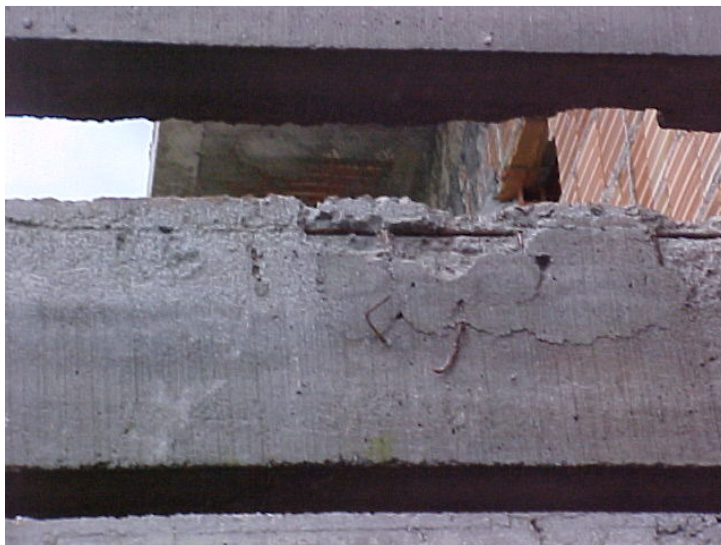
Figura 3.16 - Vigas em concreto armado sem qualidade e espessura de cobrimento. (Crea/GO)
