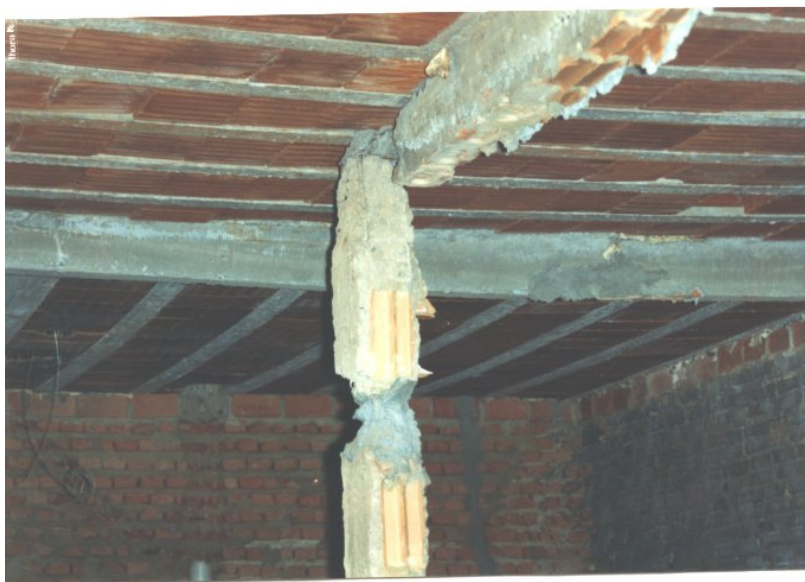
Figura 3.17 – Viga e Pilar em concreto armado sem qualidade. (Crea/GO)
