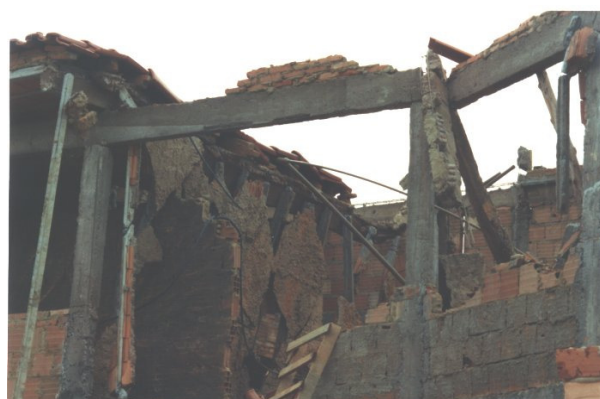
Figura 1.02 – Desabamento parcial de um sobrado com estrutura de concreto armado. (Crea/GO)
