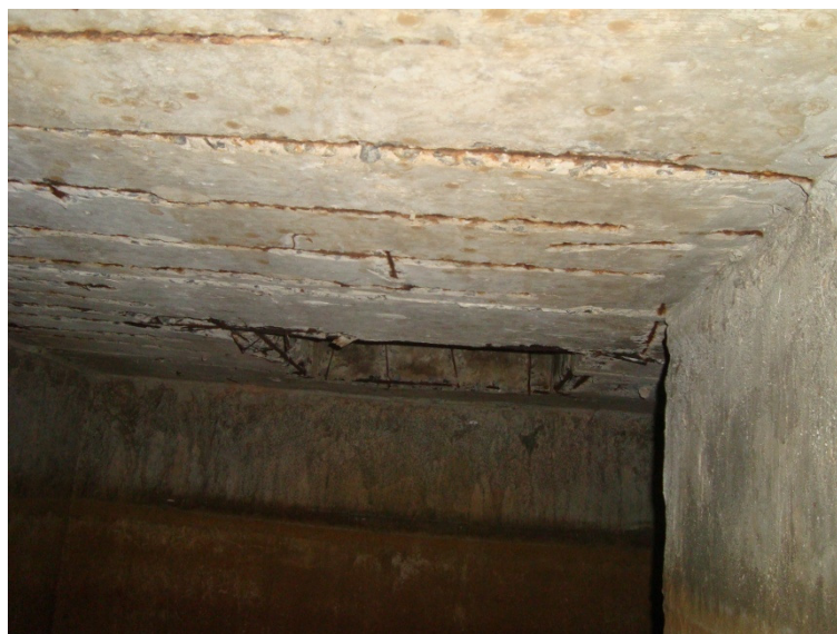
Figura 3.12– Corrosão da armadura em laje. (Crea/GO)
