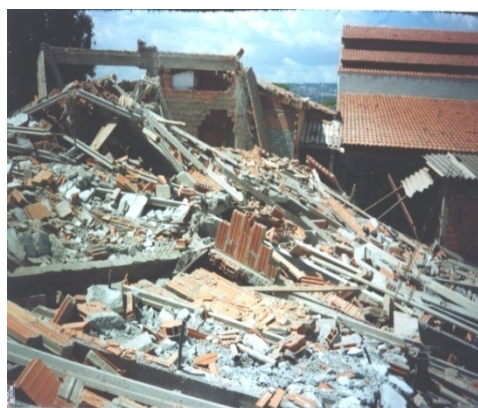
Figura 1.04 – Desabamento total de uma obra residencial/comercial com três pavimentos, executada em Goiânia/2005. (Crea/GO)
