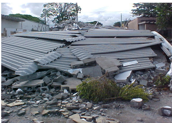
Figura 1.03 – Desabamento total de uma obra destinada à escola, executada em Goiânia/2004. (Crea/GO)
