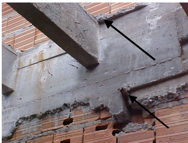
Figura 3.18- Vigas em concreto armado com irregularidades geométricas. (Crea/GO)
