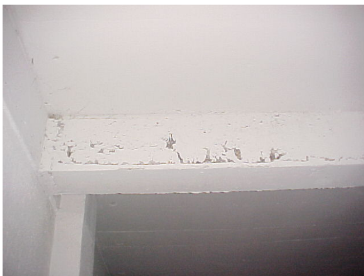
Figura 3.19- Elementos em concreto armado com segregação.(Crea/GO)
