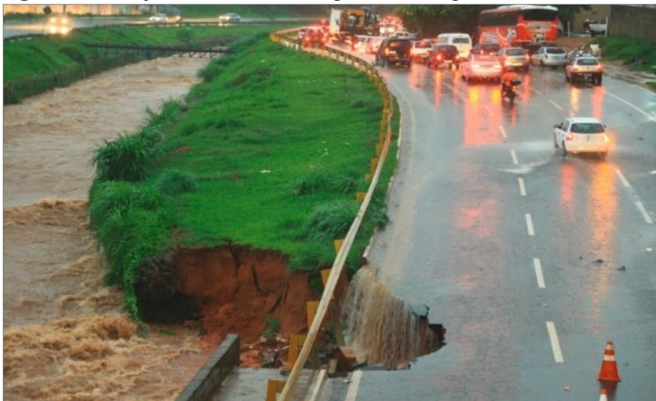
Figura 10. Feição erosiva na Marginal Botafogo, Goiânia, 2015.
