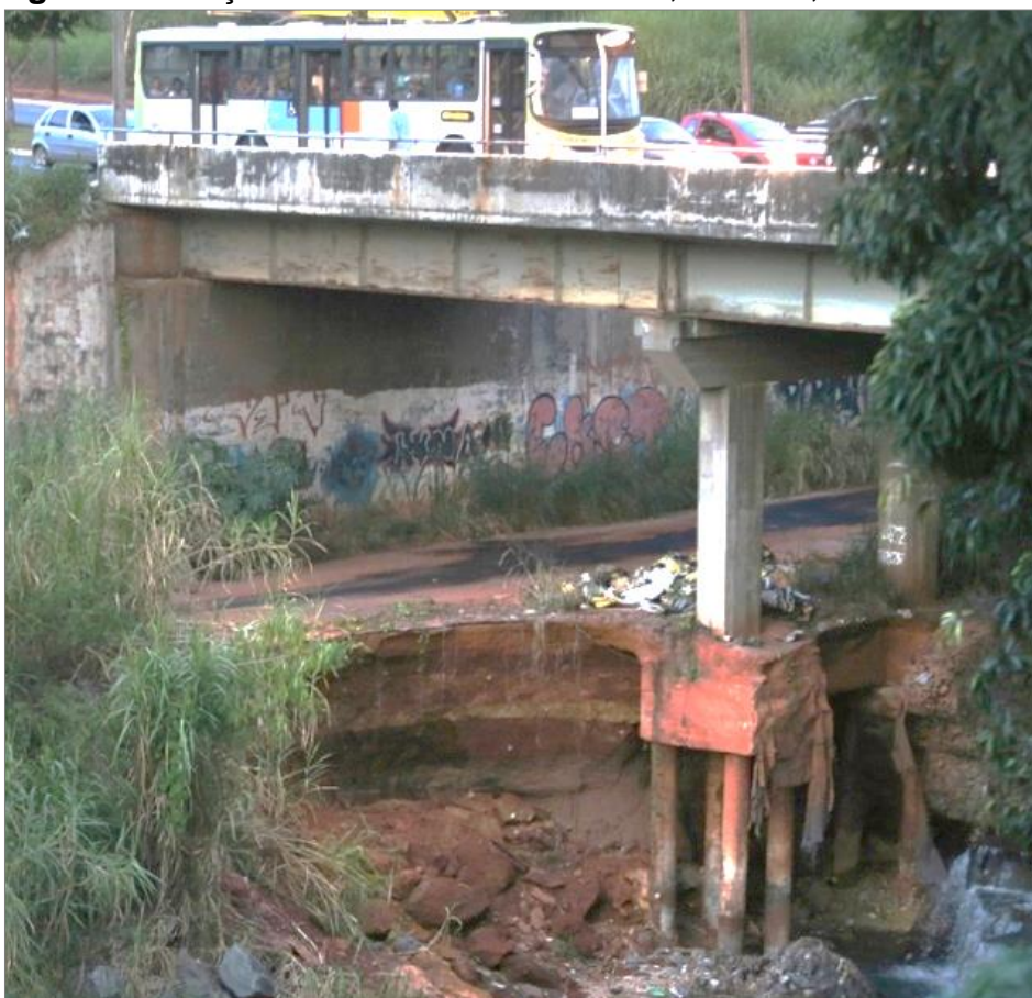
Figura 11. Feição erosiva na Avenida T-63, Goiânia, 2014.
