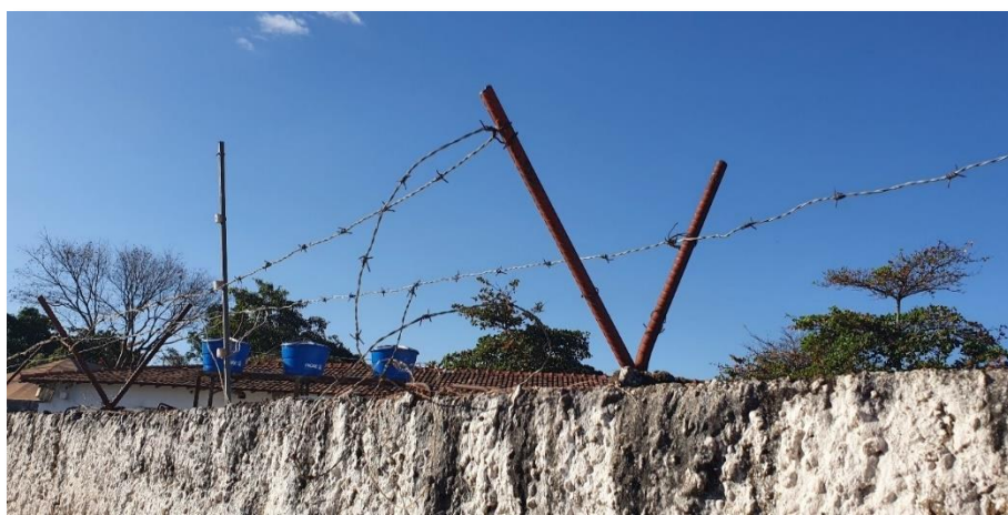
Imagem 9 - Objetos de contenção danificados na EM02
