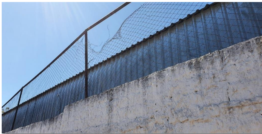
Imagem 10 - Objetos de contenção danificados na EM01
