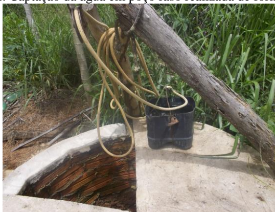
Figura 42. Captação da água em poço raso realizada de forma manual.
