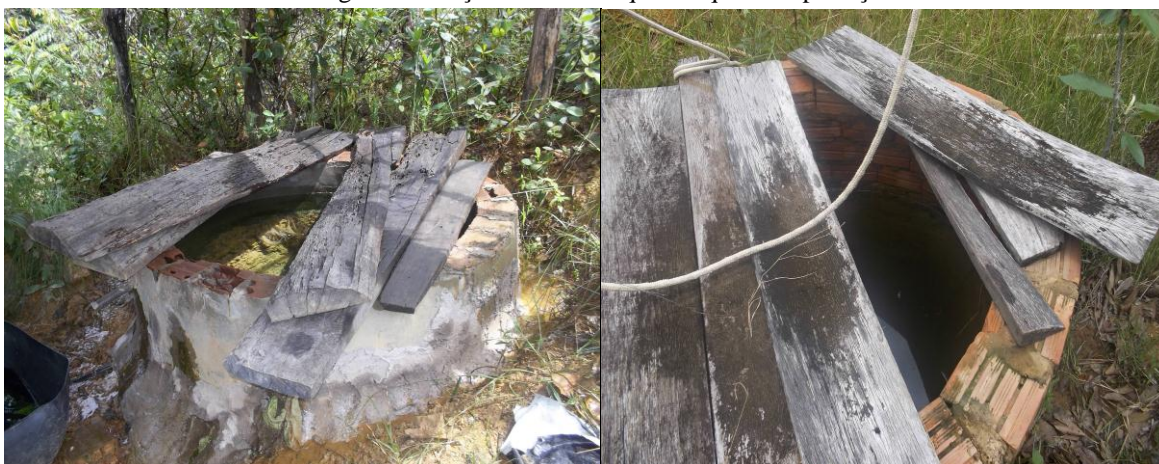
Figura 41. Poços rasos inadequados quanto à proteção.
