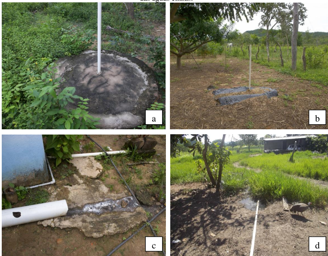
Figura 47. a) e b) Fossas rudimentares, que recebem as águas negras e c) e d) lançamento diretamente no terreno das águas cinzas.
