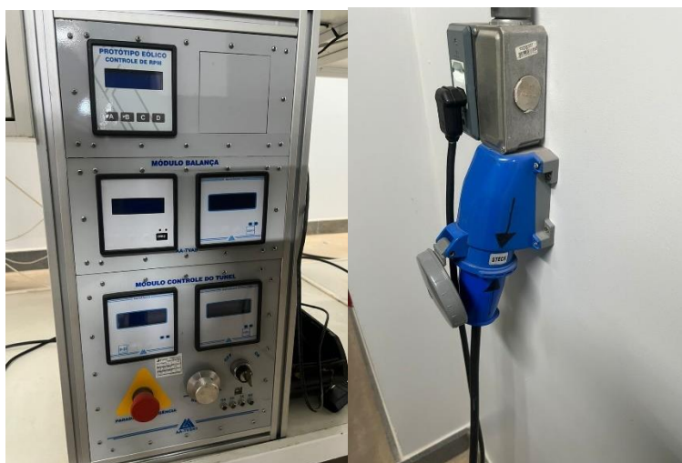
Figura 9.2: Módulo da balança, cabo de alimentação trifásico e módulo de pressão
