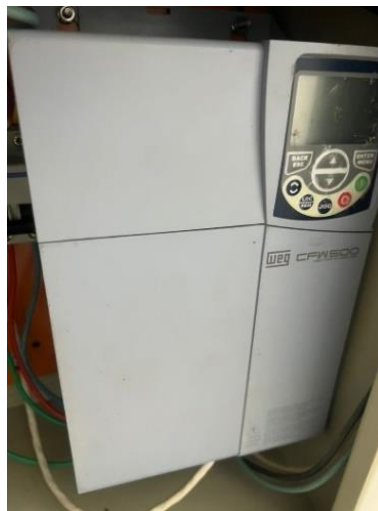
Figura 3.3: inversor de frequência do ventilador
