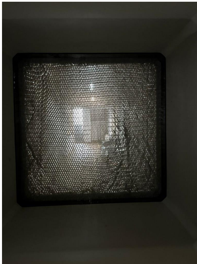
Figura 4.48: Colmeia com várias partes danificadas - parte traseira
