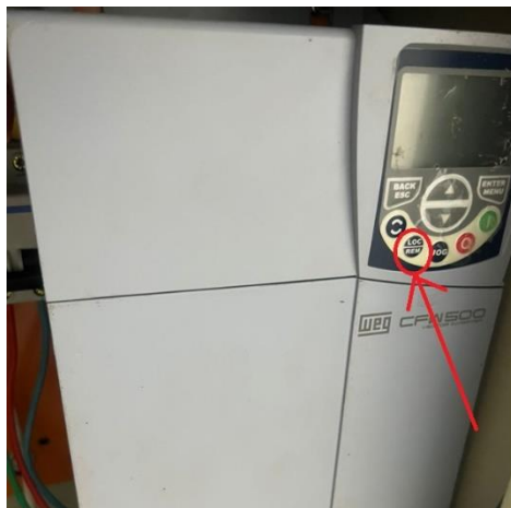
Figura 9.5. Botão rem/loc do inversor de frequência do motor do ventilador
