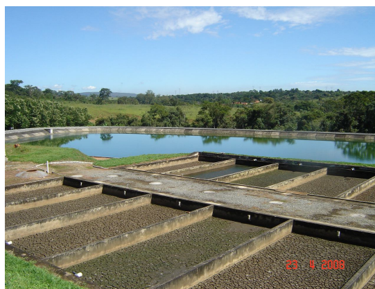
Figura 4.2.3 Vista parcial dos leitos de secagem - ETE Lages
