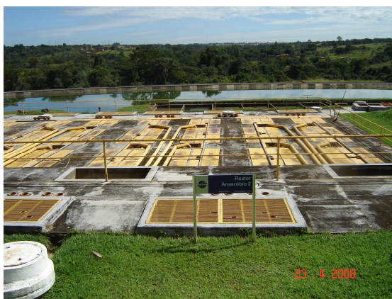
Figura 4.2.2 Vista parcial dos reatores UASB - ETE Lages
