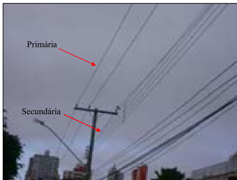
Figura 1.1 – Rede de distribuição aérea convencional.
