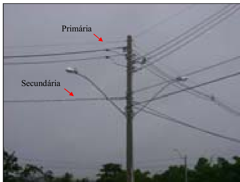
Figura 1.3 – Rede de distribuição aérea compacta
