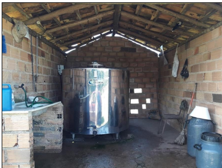
Figura 36 – Tanque de armazenamento e refrigeração de leite com capacidade para 1.380 litros no assentamento São José do Piçarrão
