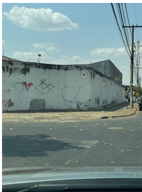
Foto 2: Registro fotográfico realizado em julho/2024 próximo ao Camelódromo de Campinas, Região Central, Goiânia/GO
