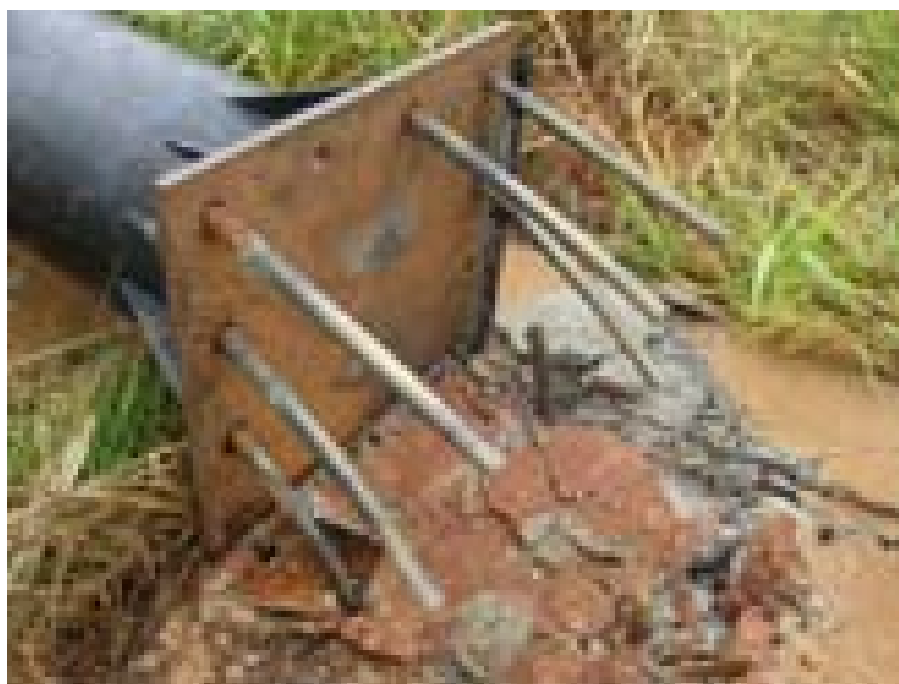
Figura 2.8 – Totem que veio à ruína na cidade de Goiânia (outubro/2010) por escorregamento da ancoragem.
