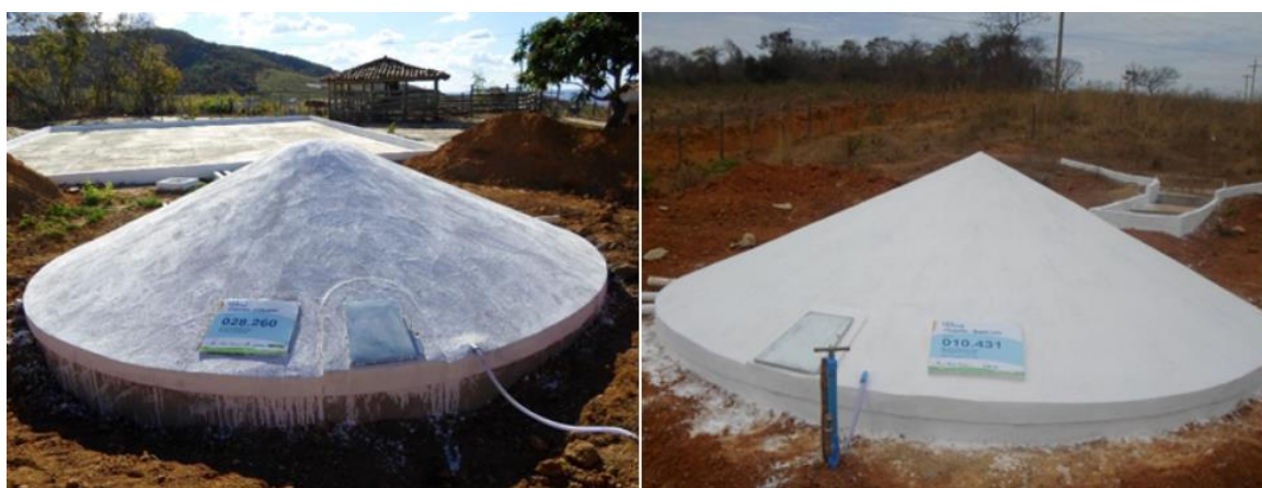
Figura 30 – Cisternas de captação da água da chuva
