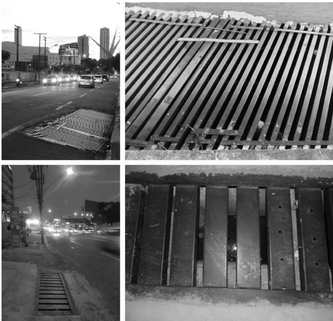
Figura 139: Fotografias referentes aos indícios do ponto 4 do mapa de indícios (Figura 134), localizados na Rua 87. Nas imagens vê-se elementos de grande porte de drenagem urbana, onde é possível ver e ouvir a passagem da água em seu interior. Fonte: Acervo fotográfico da autora (2019).
