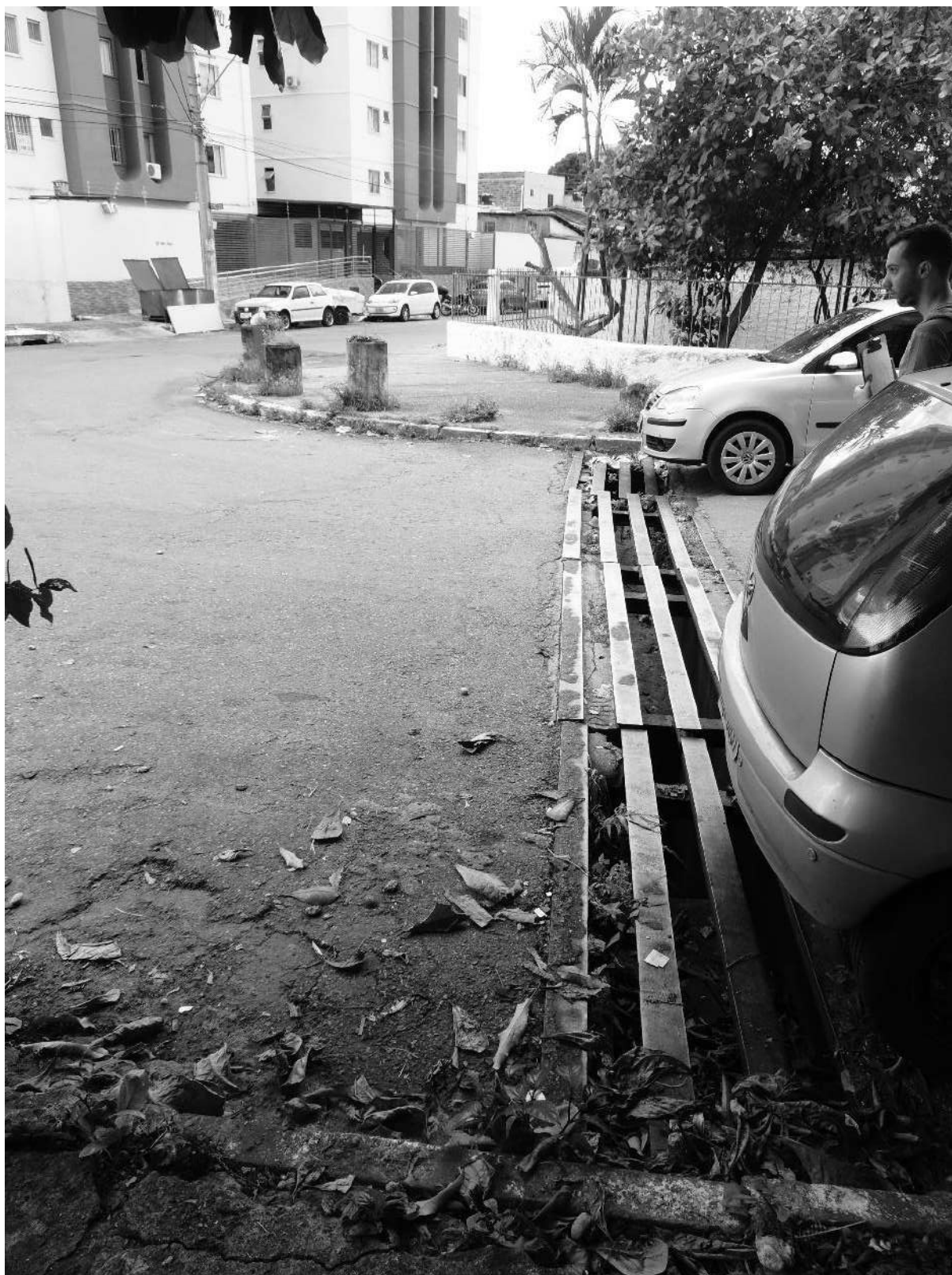
Figura 249 – Grelha de drenagem localizada na Rua 15-A.
