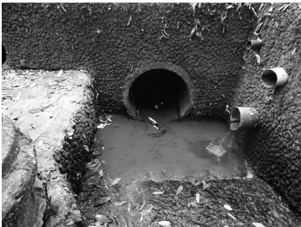
Figura 238 – Tubulação do córrego dos Buritis no Bosque dos Buritis.
