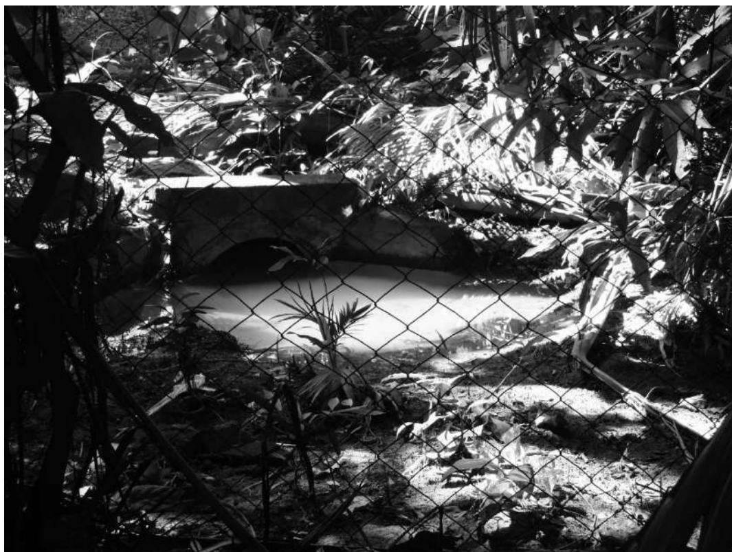
Figura 280 – Tubulação existente no terreno do Serviço Geológico do Brasil, próximo à divisa com o Clube dos Oficiais.
