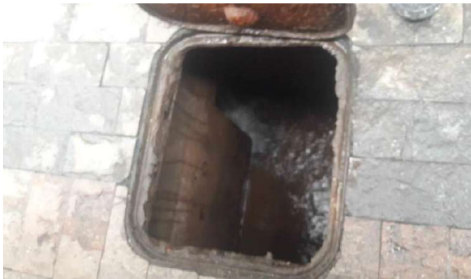
Figura 100 – Caixa de passagem localizada no estacionamento dos fundos (Rua 29), onde é possível ver a água que é captada da mina e lançada na tubulação do córrego dos Buritis.
