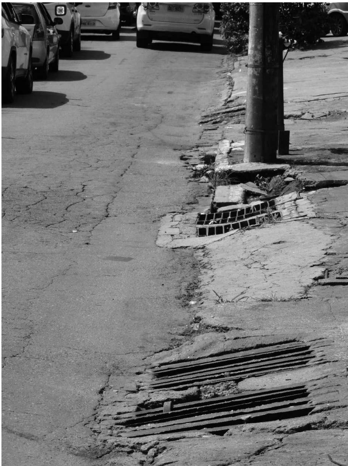
Figura 252 – Grelhas de drenagem localizada na Av. Independência.
