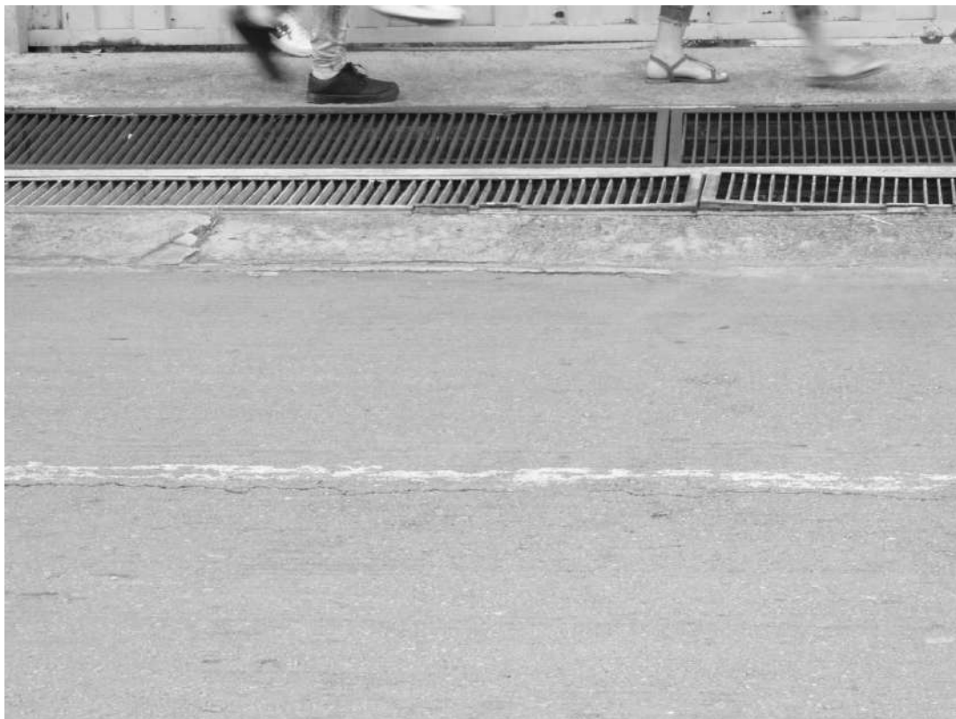
Figura 197 – Grelhas de drenagem urbana na Av. Cora Coralina, Setor Sul.
