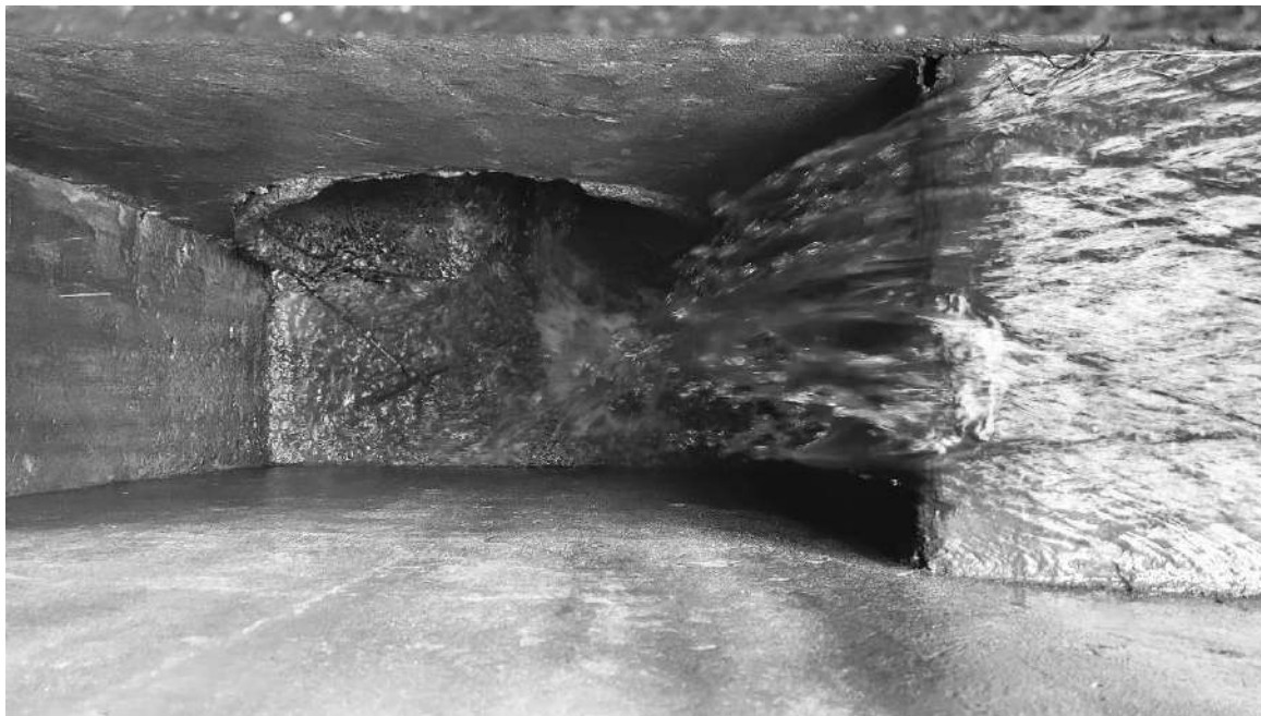
Figura 247 – Água de enxurrada que desce através da grelha de drenagem localizada na Rua 15-A e é levada para uma grande tubulação.
