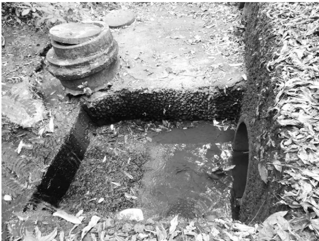
Figura 215 – Estrutura de contenção e tubulações no Bosque dos Buritis, que levam as águas do córrego dos Buritis para a canalização da Rua 29.
