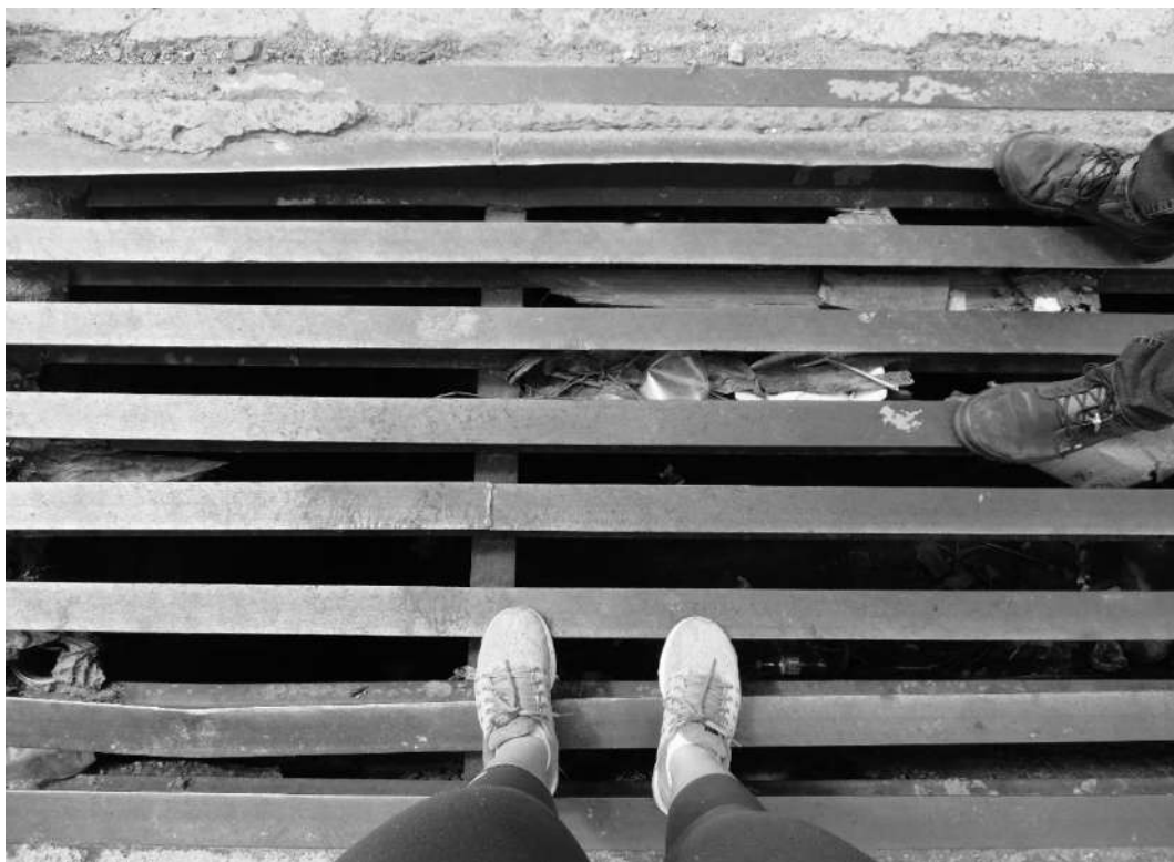
Figura 250 – Grelha de drenagem pluvial localizada na Av. Oeste.
