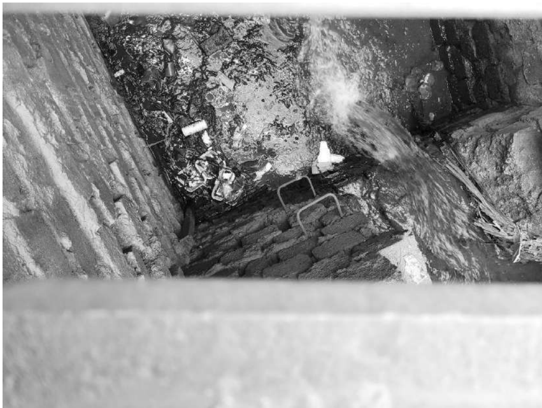
Figura 239 – Caixa de passagem localizada na Rua 87, em frente ao Instituto Goiano de Oncologia e Hematologia - INGOH.
