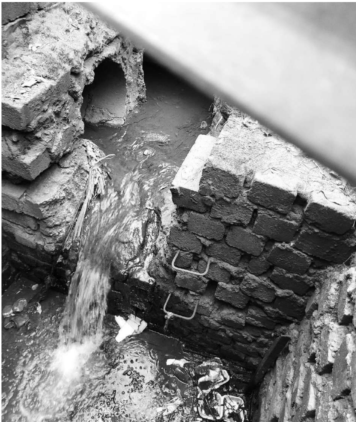
Figura 240 – Caixa de passagem localizada na Rua 87, entre o Clube dos Oficiais e o Instituto Goiano de Oncologia e Hematologia - INGOH.
