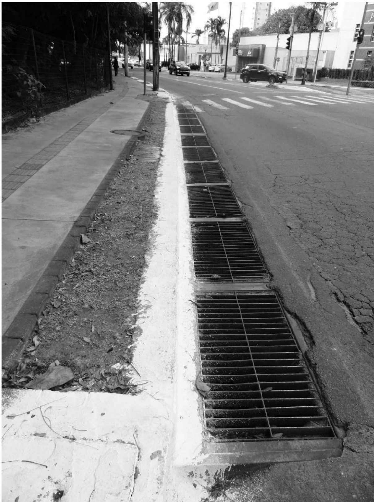
Figura 244 – Sistema de drenagem localizado na av. Assis Chateaubriand, em frente ao Tribunal de Justiça de Goiás – TJGO.
