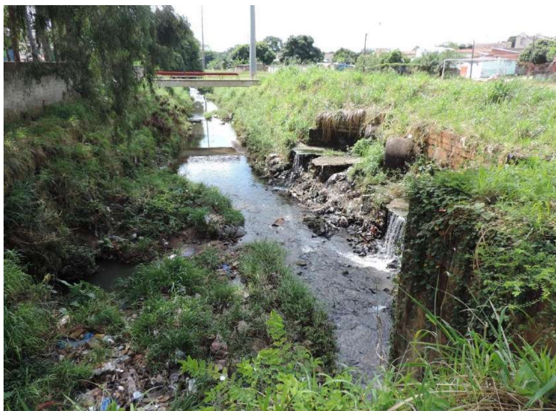
Figura 128 – Leito do córrego Capim Puba e, à direita, a tubulação de desague do córrego dos Buritis neste primeiro córrego.
