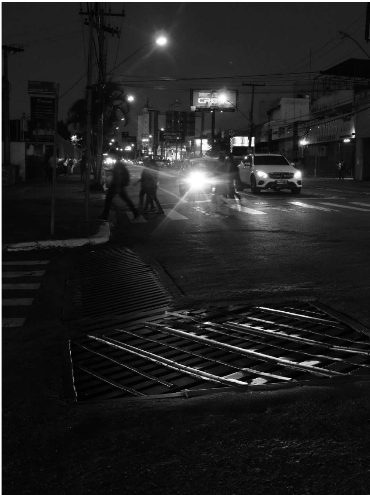
Figura 206 – Grades sobre caixa de passagem que abriga a canalização do córrego dos Buritis no encontro entre a Rua 87 e a av. Cora Coralina.
