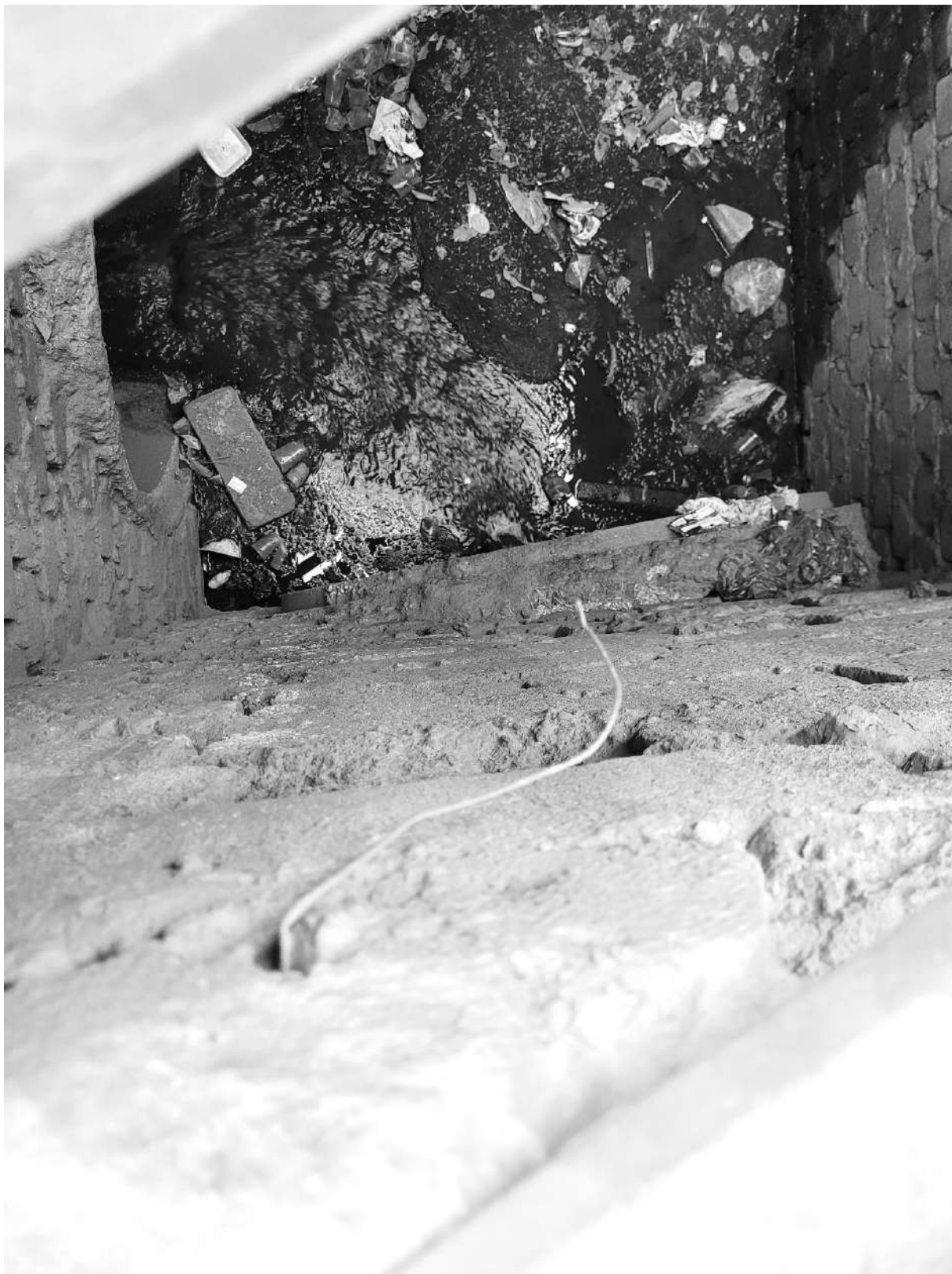
Figura 241 – Caixa de passagem localizada no encontro entre a Rua 87 e a Av. Cora Coralina.
