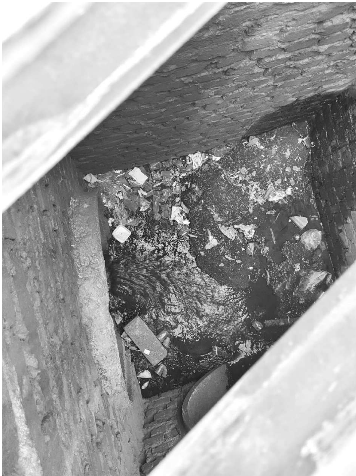
Figura 242 – Caixa de passagem localizada no encontro entre a Rua 87 e a Av. Cora Coralina.
