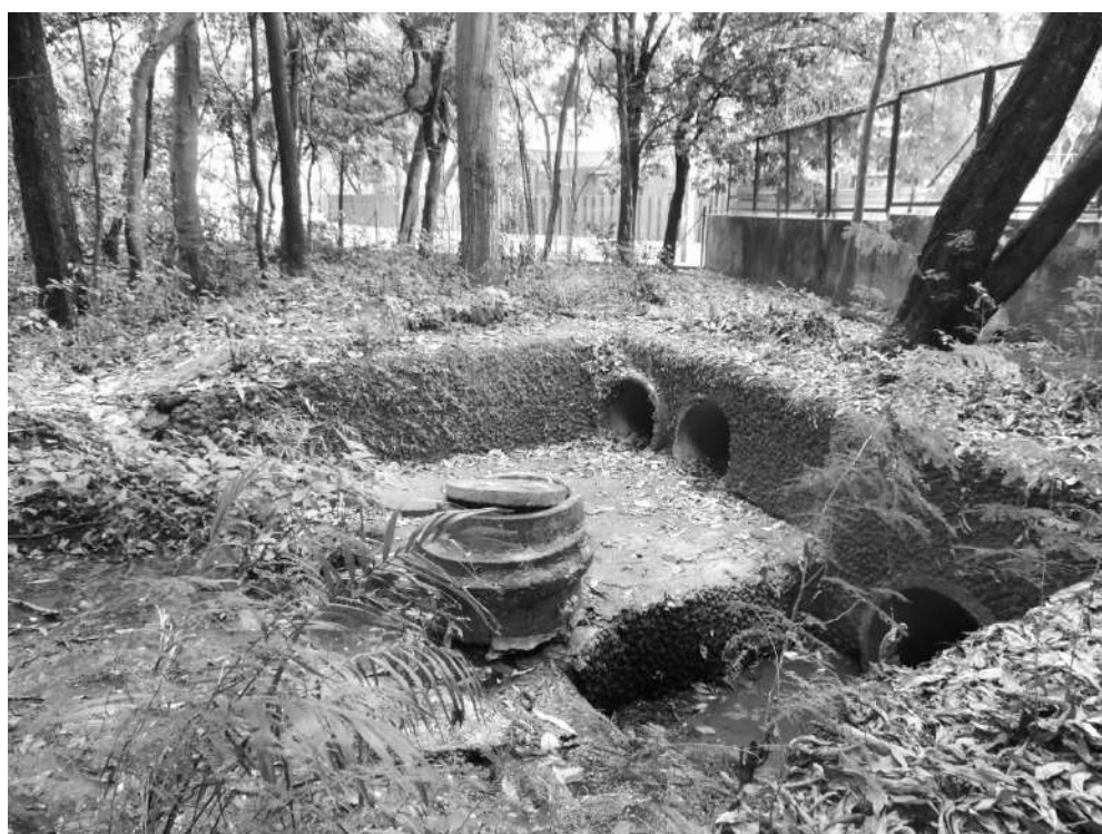
Figura 216 – Estrutura de contenção e tubulações no Bosque dos Buritis, que levam as águas do córrego dos Buritis para a canalização da Rua 29.
