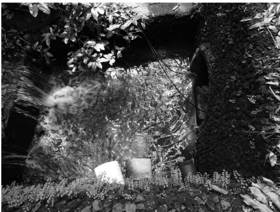
Legenda: Nas imagens vê-se o local da tubulação que leva as águas recolhidas do bosque para a Rua 29 em diante. Fonte: Acervo fotográfico da autora (2024).
