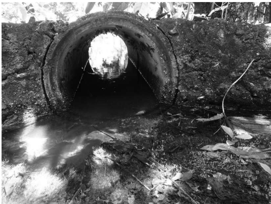
Figura 300 – Tubulação que direciona a água do córrego dos Buritis para o lago do Clube dos Oficiais.
