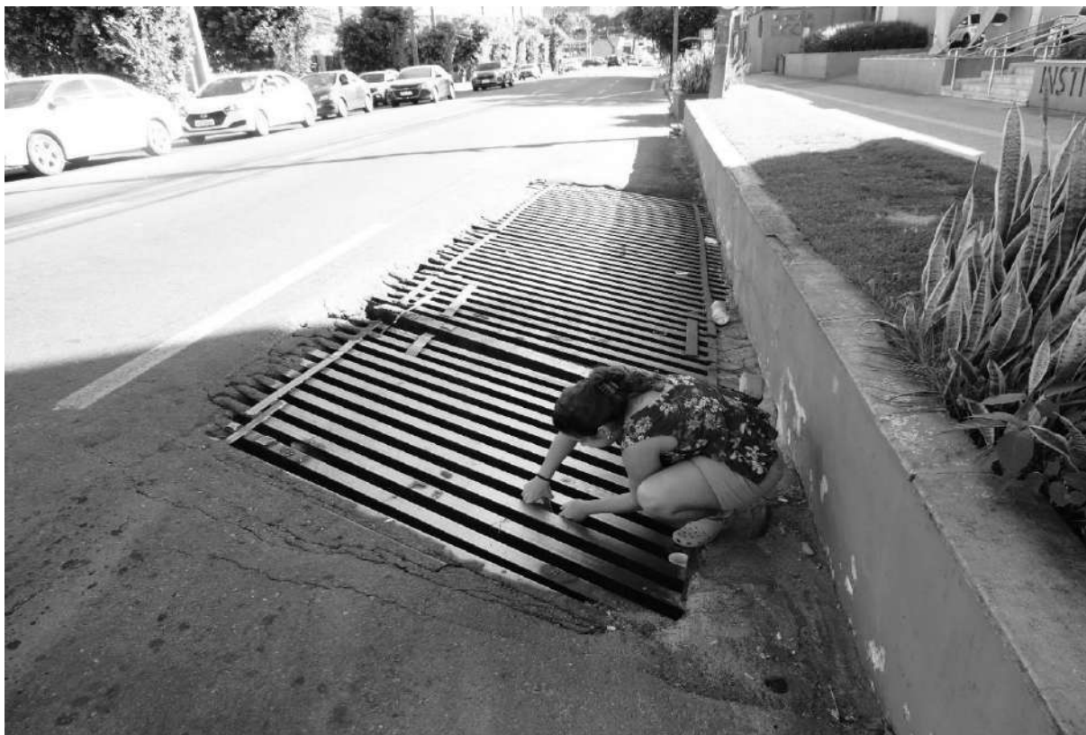
Figura 265 – Fotografia de Tiago Aleixo, 2024, do levantamento fotográfico sobre a caixa de passagem localizada na Rua 87.
