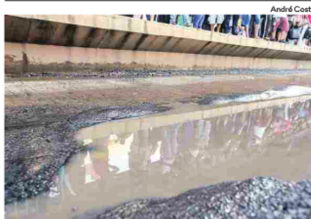
Que coisa – Água de esgoto estava acumulada em buracos em frente a plataforma de ônibus do Eixo Anhangüera, no Centro.
