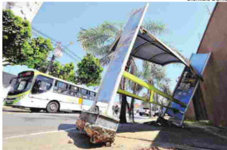
Nada mudou – Abrigo de ponto de ônibus atingido por carro, já mostrado pela coluna, permanece esquecido. A estrutura danificada fica na Rua 88, no Setor Sul.
