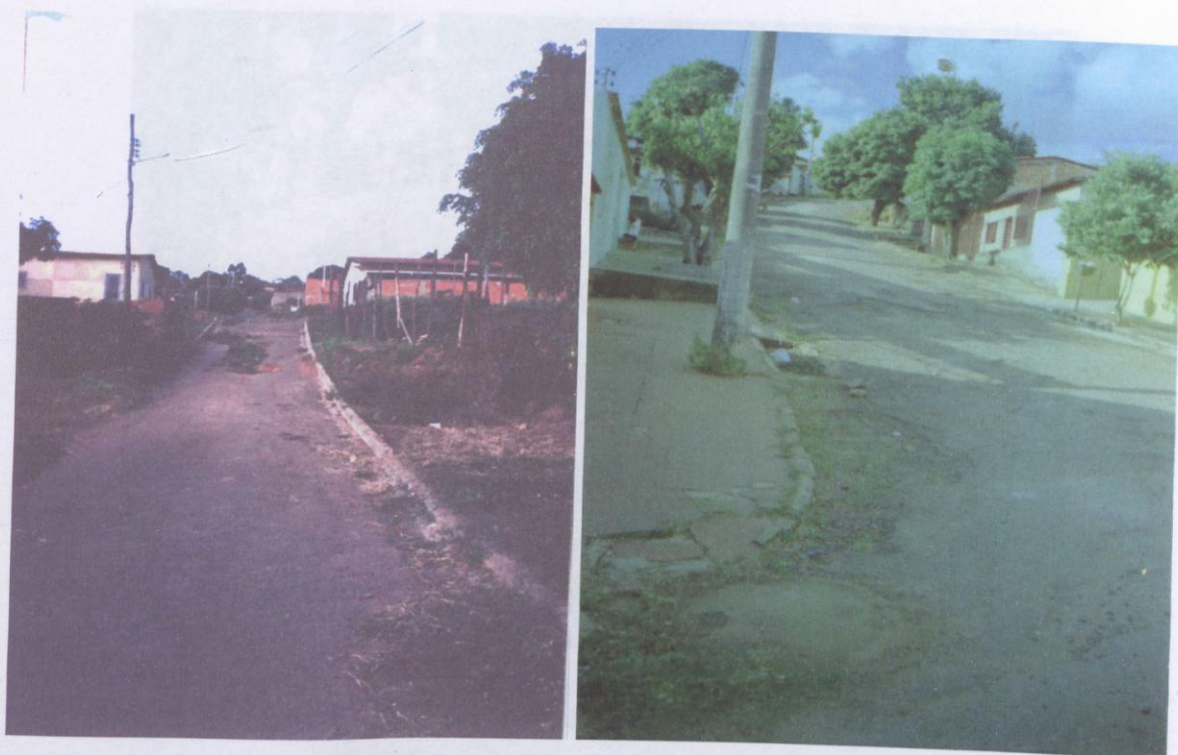
Foto 3-Rua Aluizio de Azevedo, Jardim Santana Foto 4-Rua Oriente, Bairro São Jorge Arruamentos inadequados, perpendiculares à rede de drenagem
