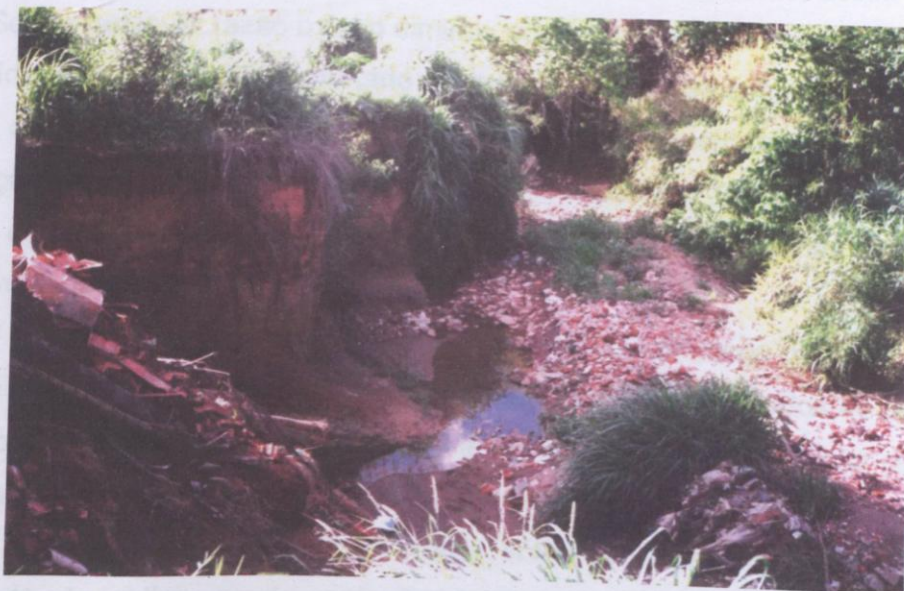
Foto 17 – Degradação do leito e margens do córrego Catingueiro. Bairro Jardim Petrópolis.
