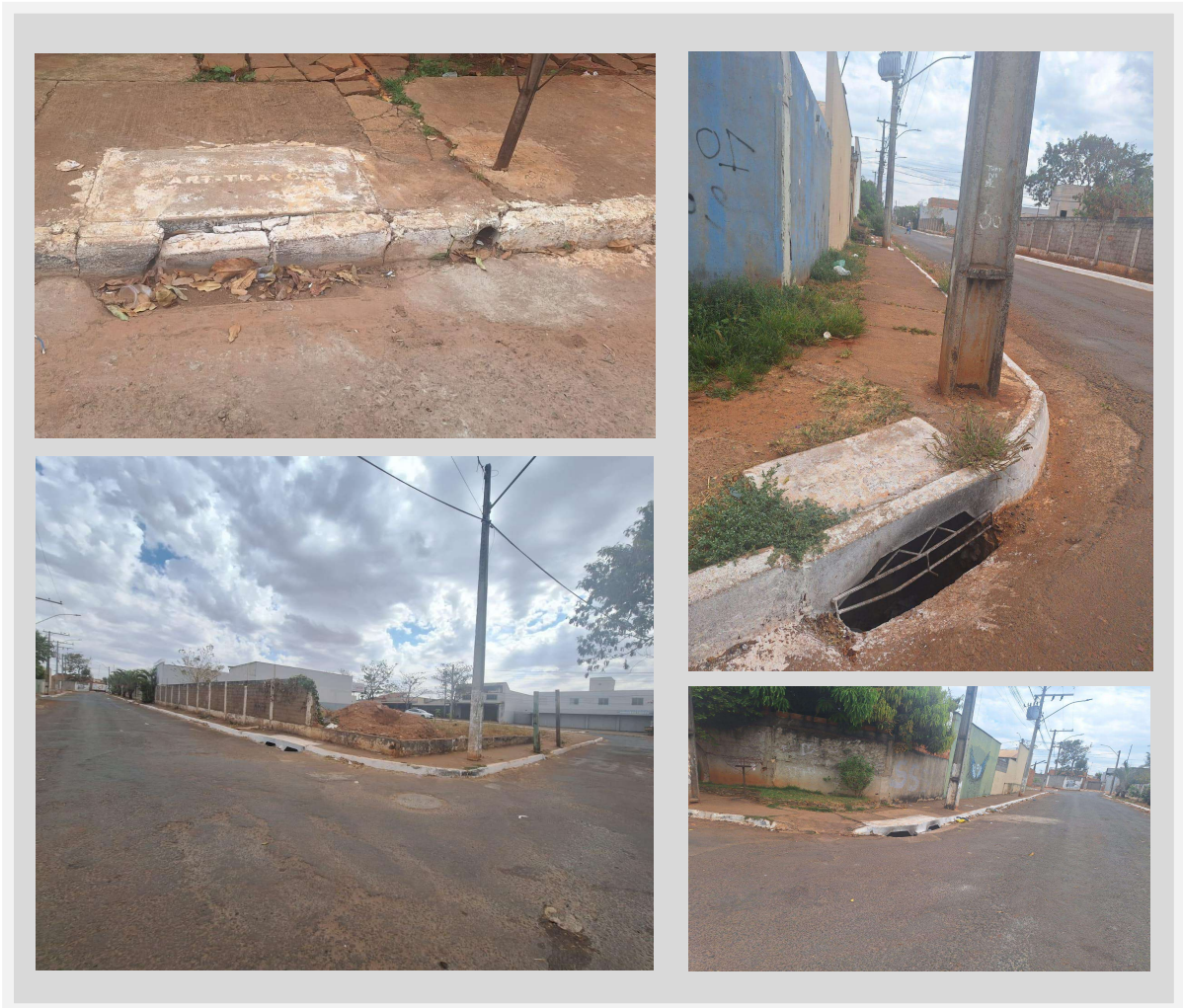
Figura 14- Imagens de bocas de lobo do Condomínio Palace São Francisco, Senador Canedo (GO)
