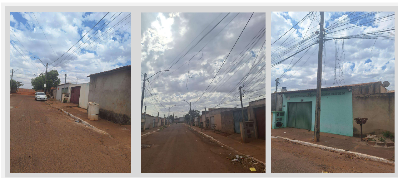
Figura 20- Imagem de calçada degradada e não acessível à esquerda e imagens de fios da rede elétrica, de telefonia e internet degradados à direita, no Condomínio Palace São Francisco, Senador Canedo (GO)
