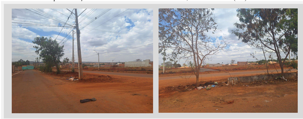
Figura 11- Imagens do local de retirada dos muros do condomínio com degradação das calçadas e da pavimentação no Condomínio Palace São Francisco, Senador Canedo (GO)
