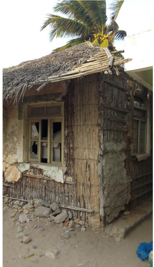
Figura 71: Casa macuti original em estado avançado de deterioração 2019. Foto do autor.
