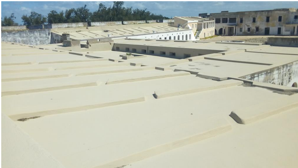
Figura 87: Rede de canaletas feitas para captação da água da chuva e destinação para as cisternas de armazenamento na Fortaleza de São Sebastião 2019. Foto do autor.
