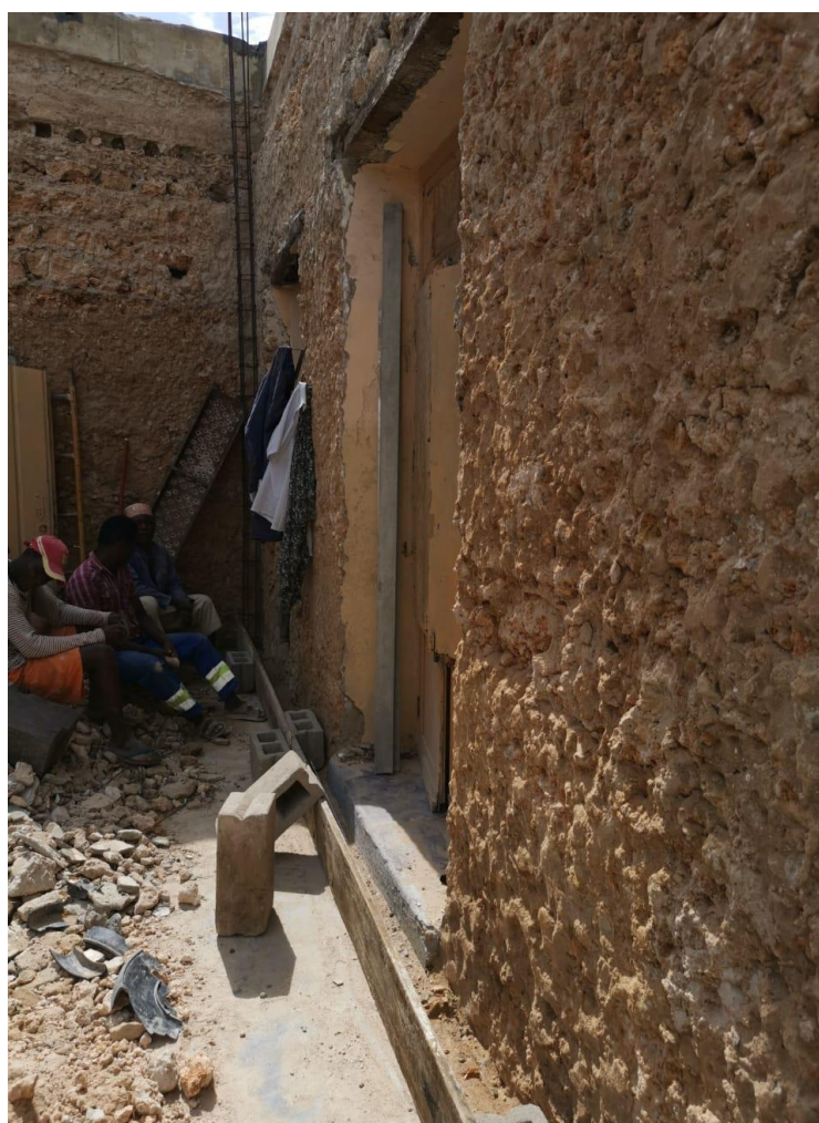
Figura 60: Paredes internas de um antigo armazém descascadas 2019. Foto de Didi.
