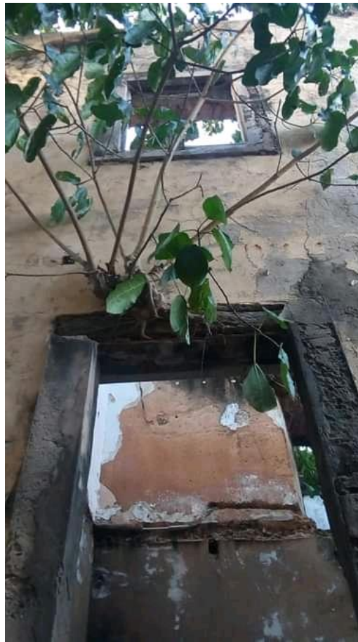
Figura 43: Detalhe para uma Figueira nascendo na parede de um imóvel em ruína 2019. Foto do autor.
