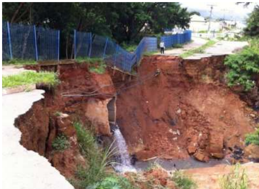
Figura 01 – Imagens da erosão no Parque tamanduá
