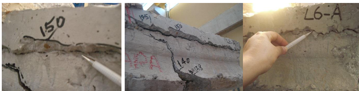
d) Descolamento da capa 01 e) Descolamento da capa 02 f) Descolamento da capa 03
