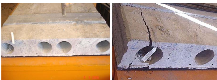
Figura 2.13 – Ruptura por torção na nervura externa da laje. (COSTA, 2009)
