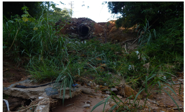
Figura 89 - Erosão. Bacia do córrego Almeida. Fonte: Fotografia de Belizario, W. (2015)
