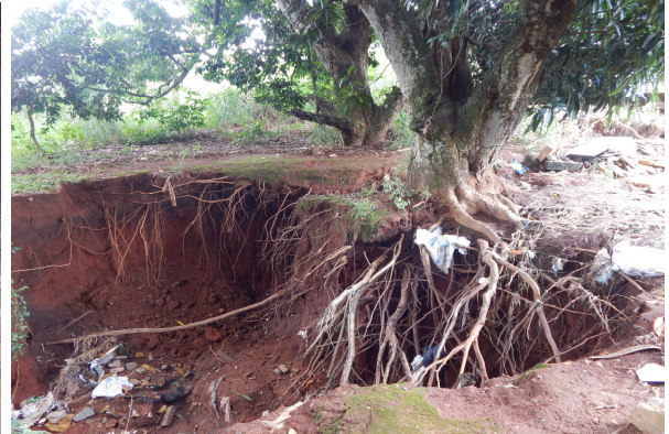
Figura 85 - Erosão. Bacia do córrego Almeida. Fonte: Fotografia de Belizario, W. (2015)
