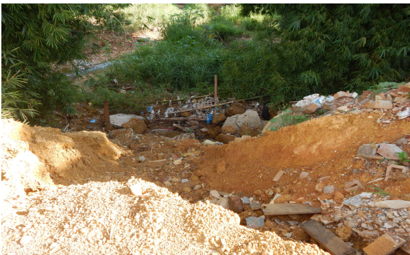
Figura 88 - Erosão. Bacia do córrego Almeida. Fonte: Fotografia de Belizario, W. (2015)
