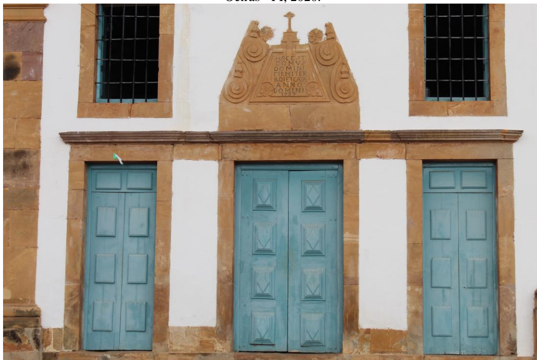
Figura 13 - Detalhe das portas principais e sobrevergas da Igreja Matriz de Nossa Senhora das Vitórias, Oeiras - PI, 2020.
